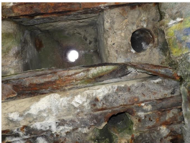
Foto 17: Bunker nummer 1, type 612. Openingen doorheen het dak ter hoogte van de achtermuur. Foto genomen op 5 augustus 2019.
