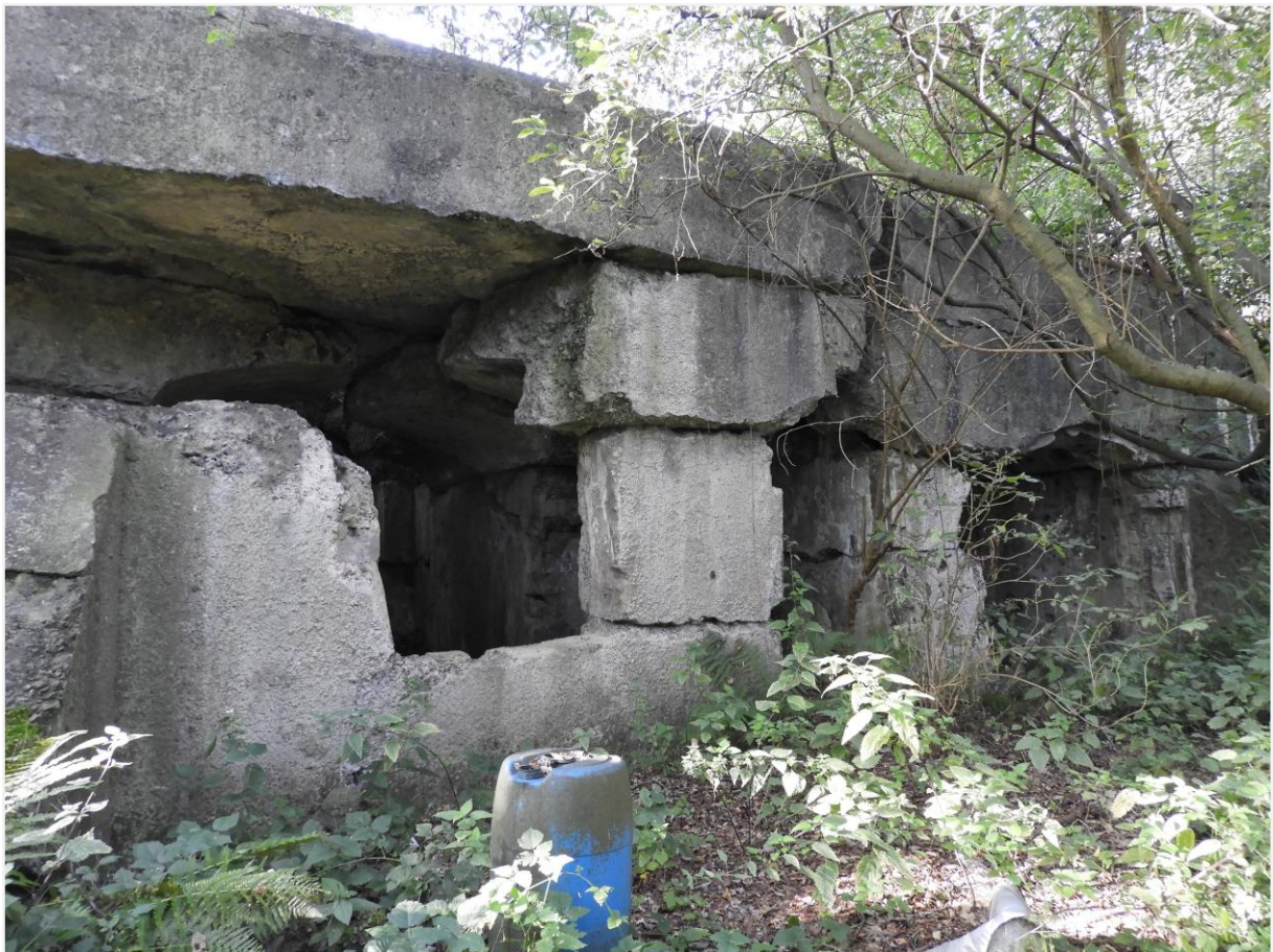
Foto 14: De betonnen geschutkoepel, gedynamiteerd in 1944, is nu een ruïne. De brokstukken liggen nog in hun onderling verband. Maar het gebouw is gescheurd en opengebarsten
