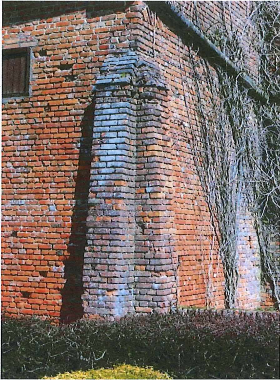
Foto 14: de met steunberen versterkte hoek van de voorgevel en de zijgevel van de schuur.
