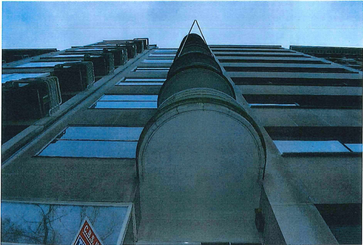
Foto 4: Voorgevel: verschil in plaatsing vensters (in het gevelvlak/verdiept)
