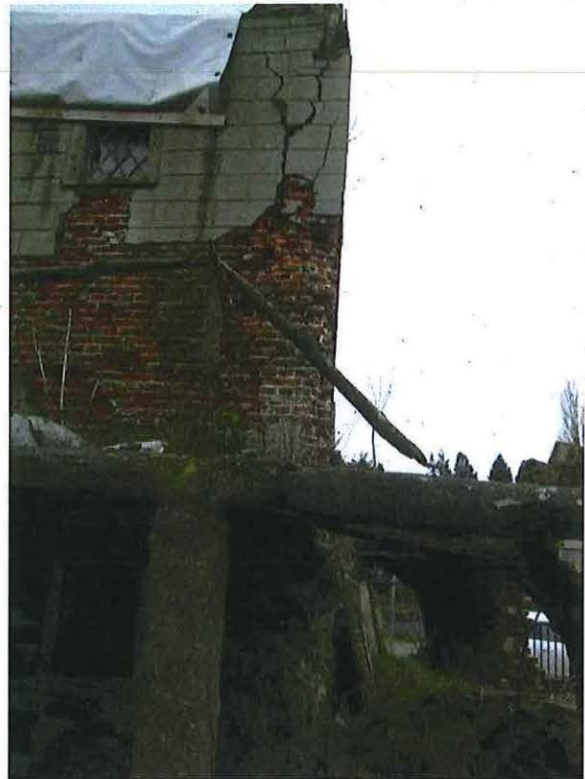
Foto 7: Verticale scheurvorming in de noordwestelijke hoek (© Triconsult 07/02/2017).
