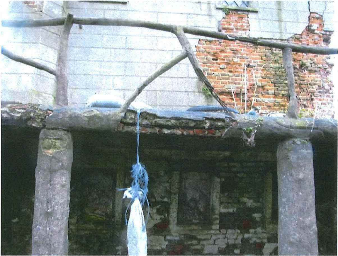
Foto 19: Corrosie van de wapening van het betonnen platform (© Triconsult 07/02/2017).
