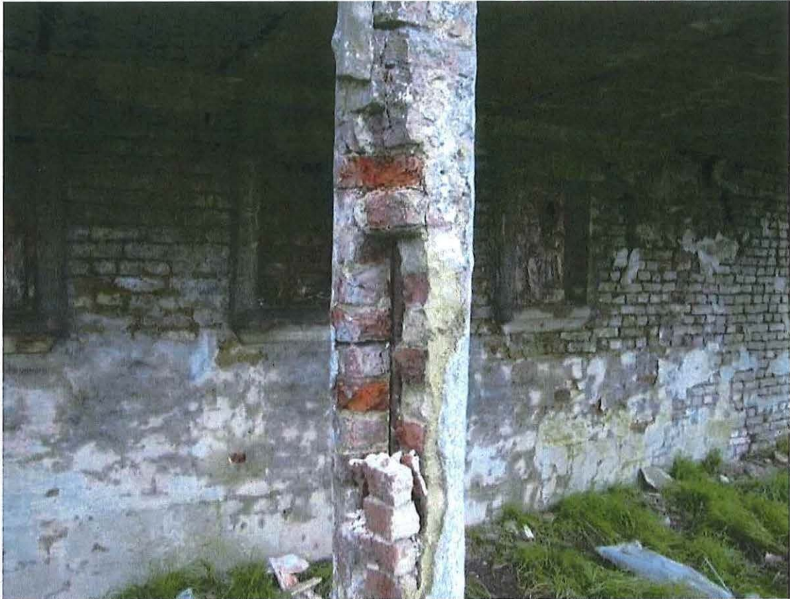
Foto 17: Detail kolommen, loszittend metselwerk en corrosie van de wapening (© Triconsult 07/02/2017).
