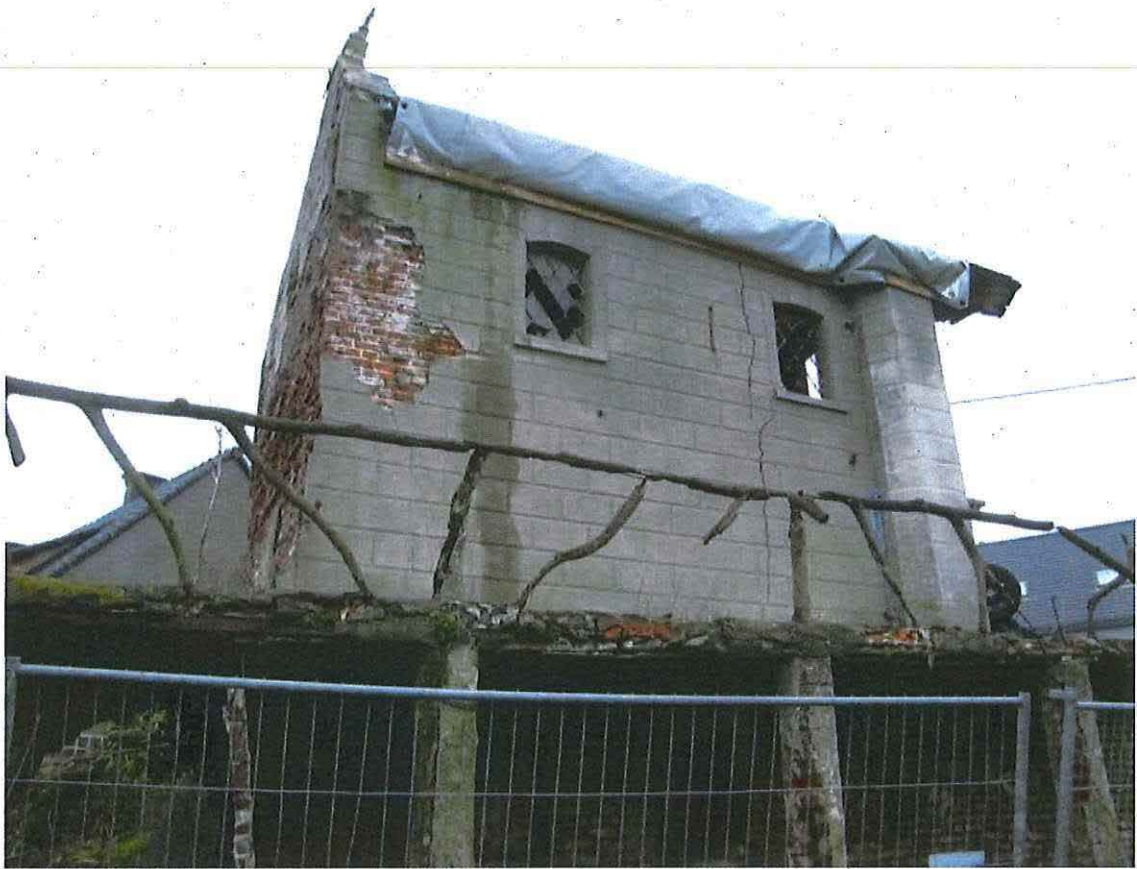
Foto 11: Zuidoostelijke zijgevel (© Triconsult 07/02/2017).
