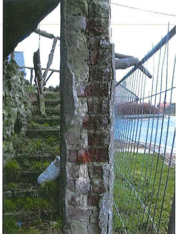
Foto 27: Scheurvorming van de kolommen (© Triconsult 07/02/2017).
