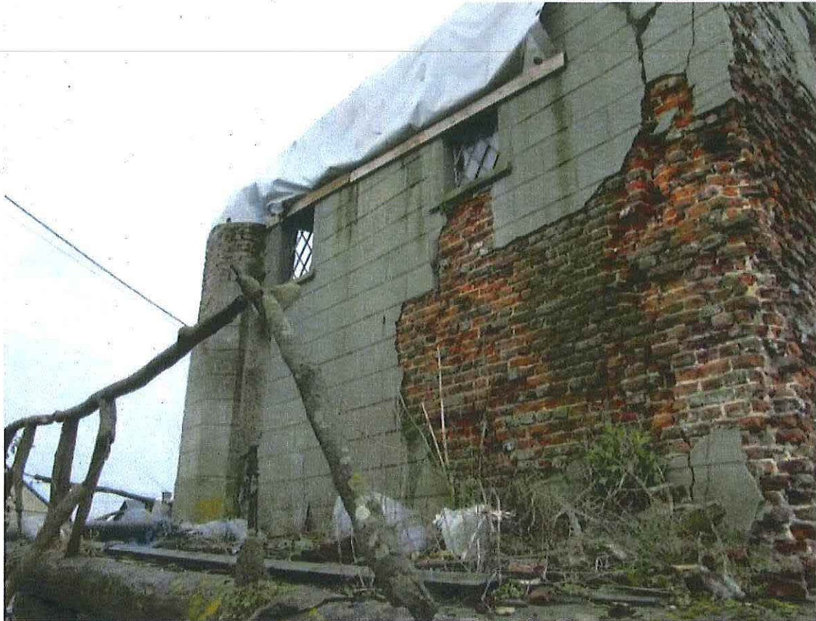
Foto 13: Zicht op de zuidoostelijke zijgevel bovenbouw en omgang met deels ingestorte borstwering (© Triconsult 07/02/2017).
