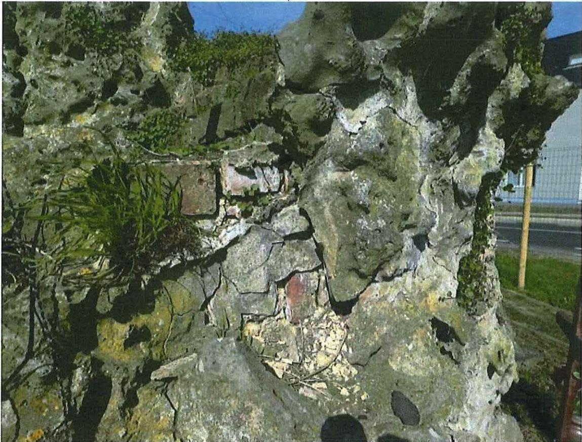
Foto 31: Detail rotseerwerk (© Bressers Architecten 22/11/2017).
