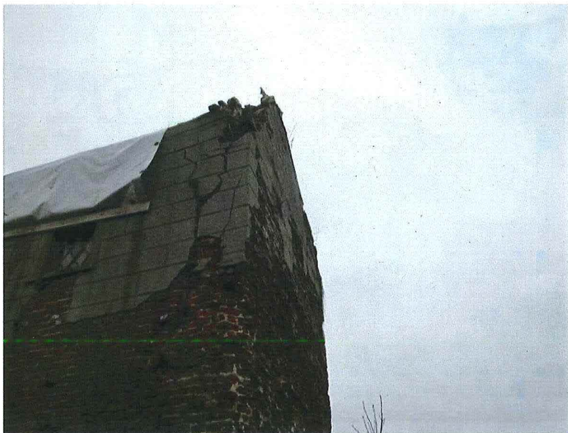
Foto 14: Verticale scheurvorming ter hoogte van de noordwestelijke hoek van de achtergevel (© Triconsult 07/02/2017).
