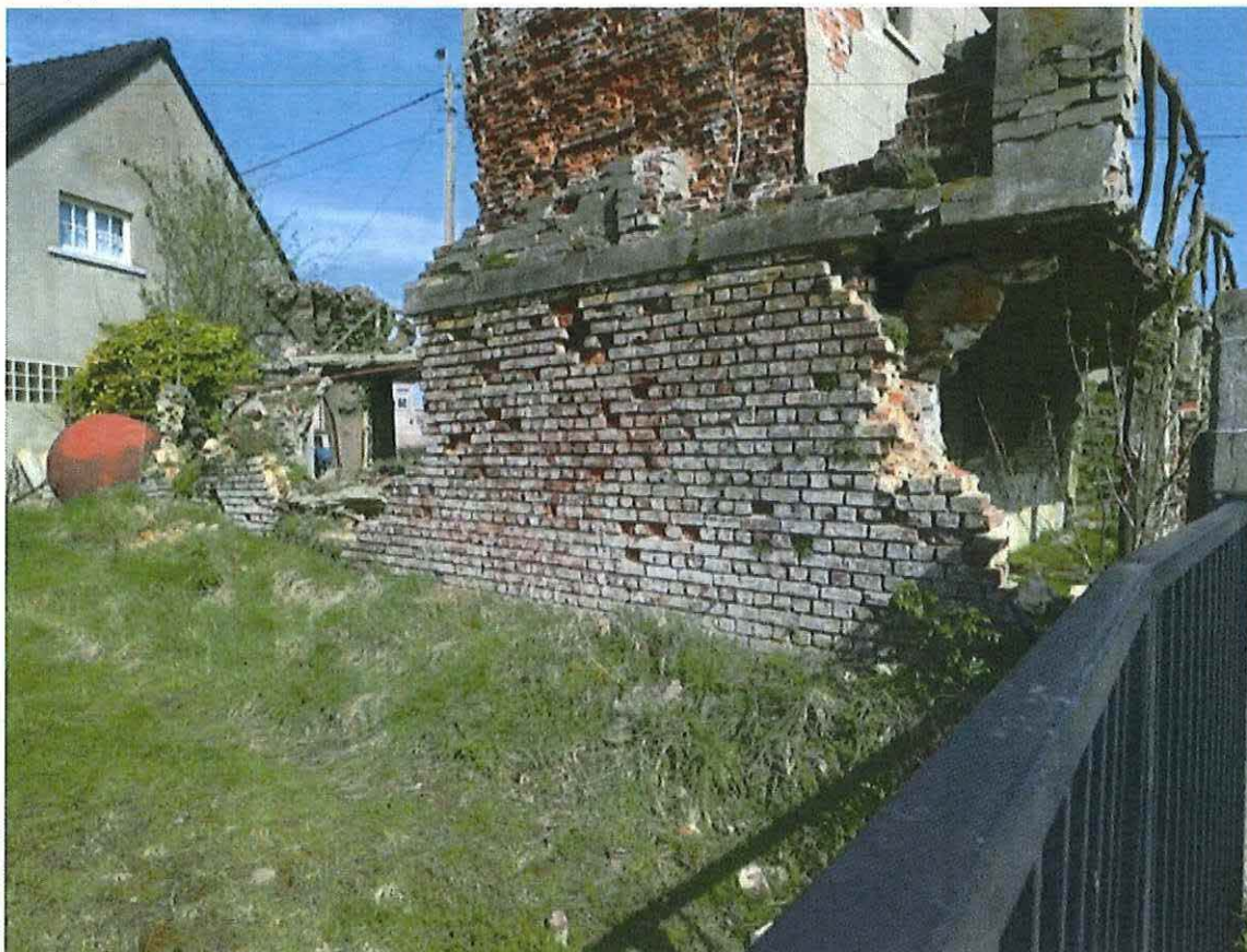
Foto 9: Zicht op deels ingestorte muur achtergevel ter hoogte van de onderbouw (© Bressers Architecten 22/11/2017).
