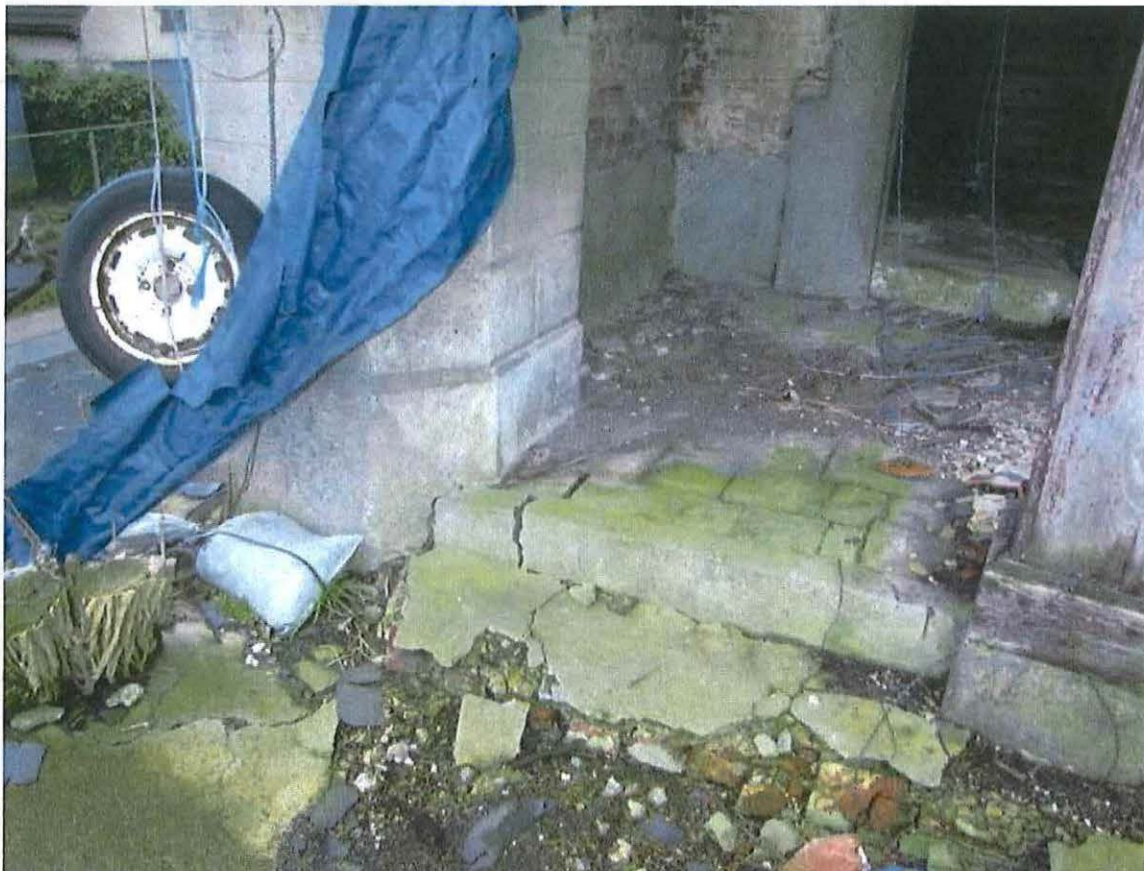
Foto 41: Detail kapelportiek van de bovenbouw met gebarsten hardstenen dorpels (© Triconsult 07/02/2017).
