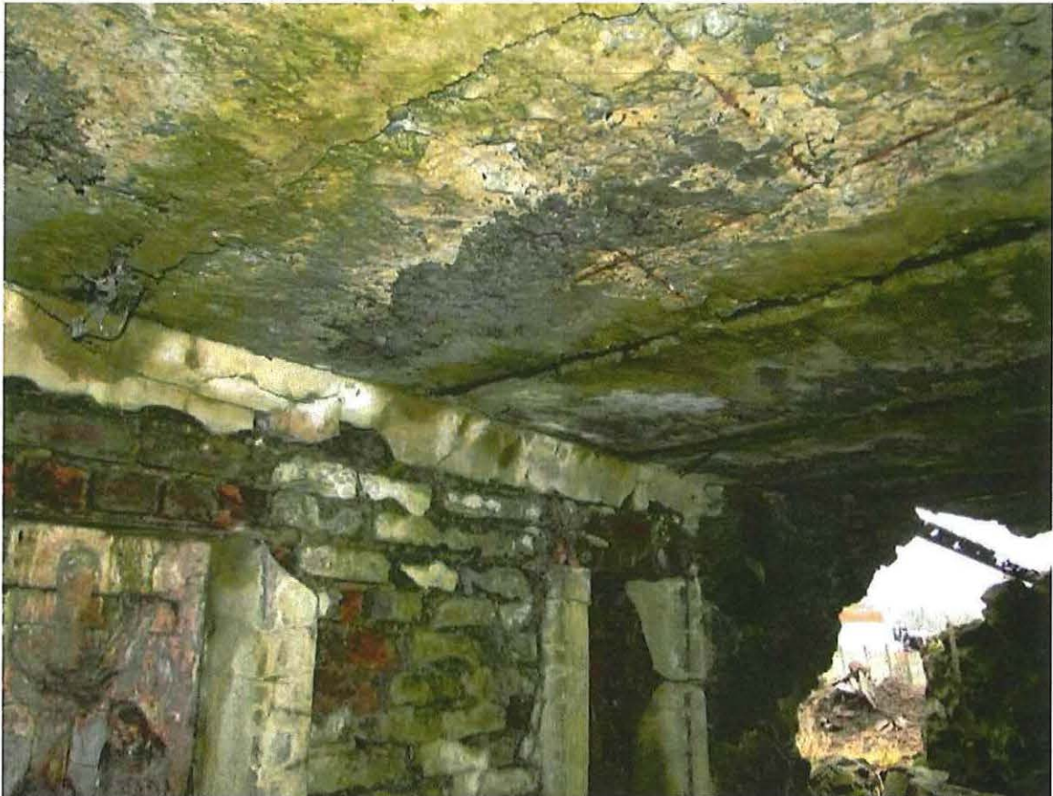
Foto 23: Corrosie van de wapening van het betonnen platform (© Triconsult 07/02/2017)
