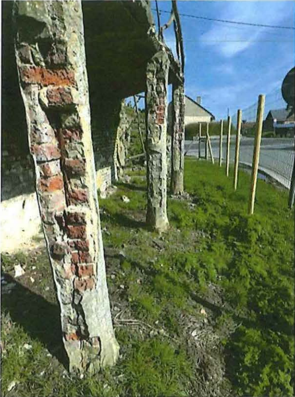
Foto 26: Scheurvorming en corrosie van de wapening kolommen (© Bressers Architecten 22/11/2017).
