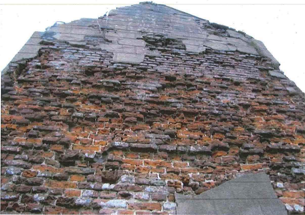
Foto 15: Aantasting van het opgaand metselwerk van de achtergevel (© Triconsult 07/02/2017).
