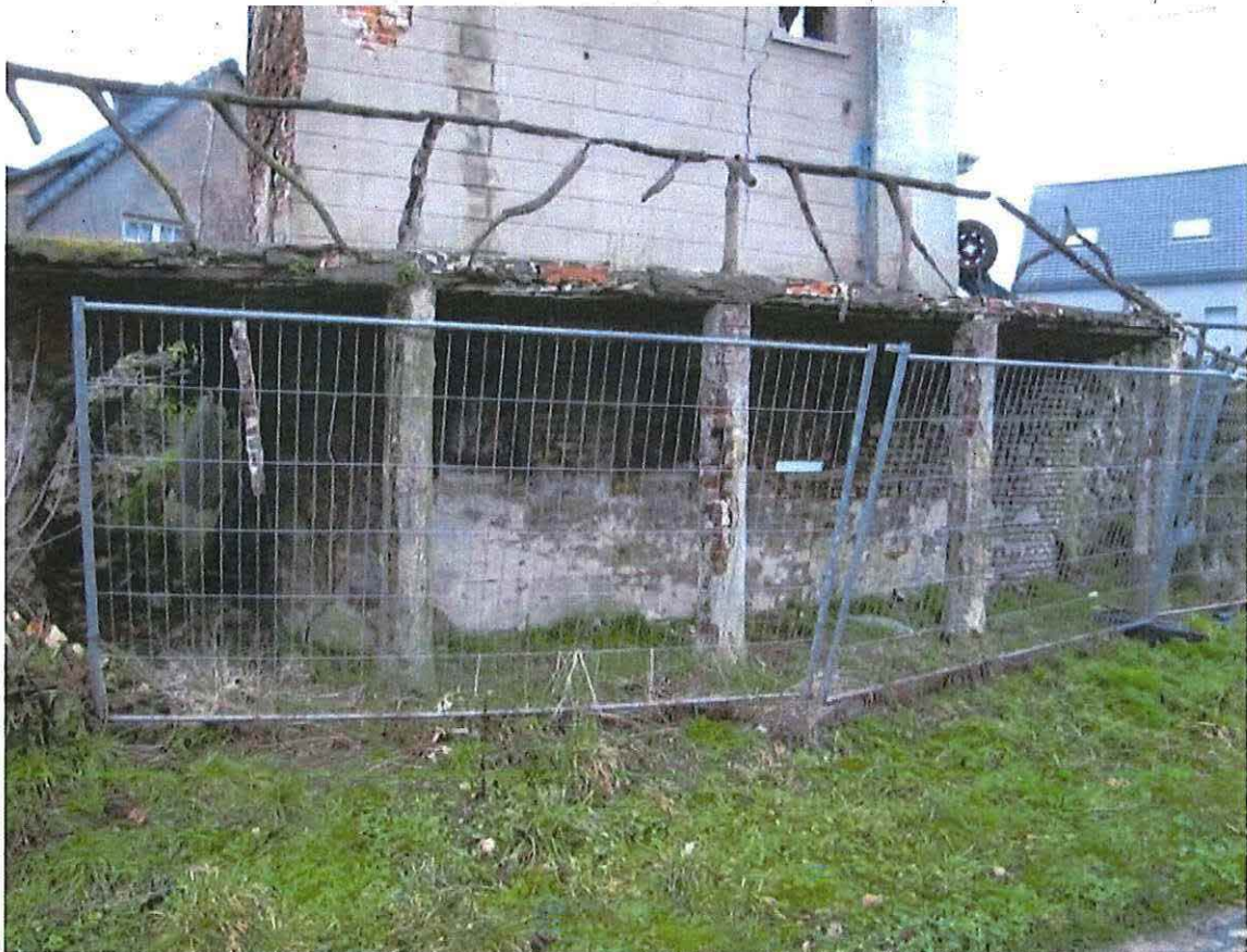
Foto 16: Zuidoostelijke zijgevel (© Triconsult 07/02/2017).
