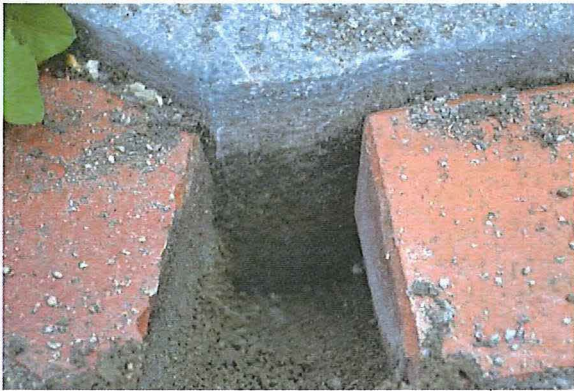
Foto 16: detail sokkel te diep geplaast
