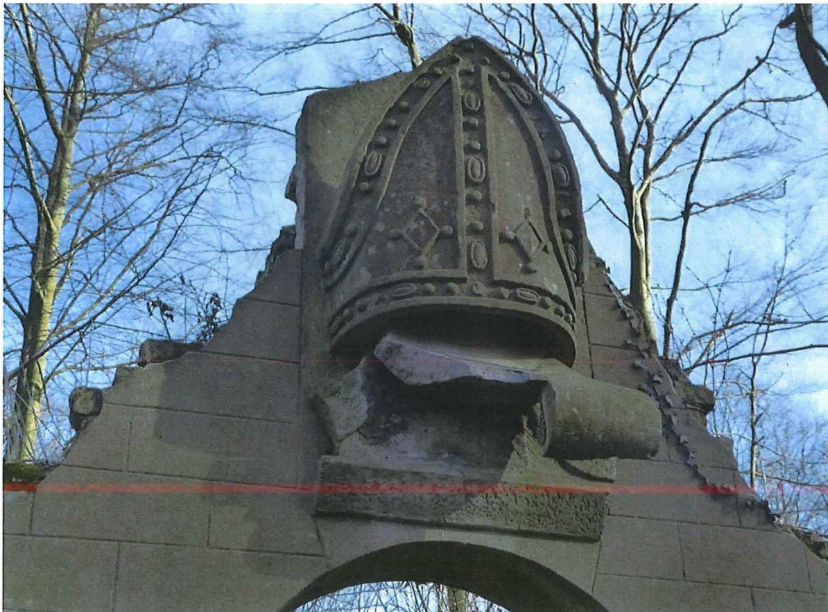
Foto 7: detail van de beschadigde mijterversiering boven het portaal van de kapel Onze-Lieve-Vrouw van Halle.
