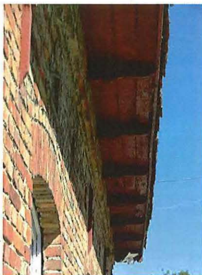
Foto 12: dakrand op modillons aan de erfzijde.
