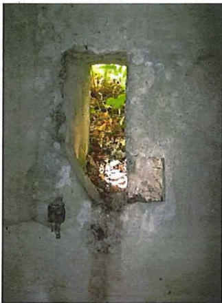
Foto 100: Bunker 49 (type VI). Vrij grote opening in achtermuur. Foto genomen door Tom Oliviers op 5 mei 2014.
