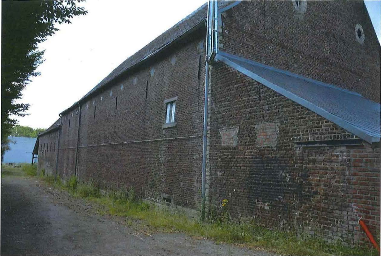
Foto 5: De noordoostelijke vleugel, nagenoeg volledig gesloten buitengevel. Het hoger volume bevat de schuur, het achterliggend lager volume is het wagenhuis met aanpalende stal.
