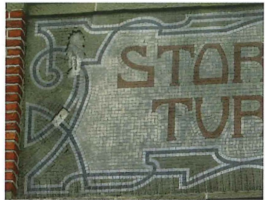
Foto 13: Vierde travee, detail schade mozaïekpaneel.
