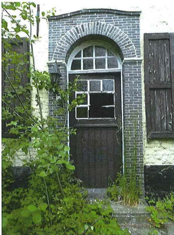
Foto 12: Boerenhuis, verankerde erfgevel, voordeur. Schade ten gevolge van vandalisme
