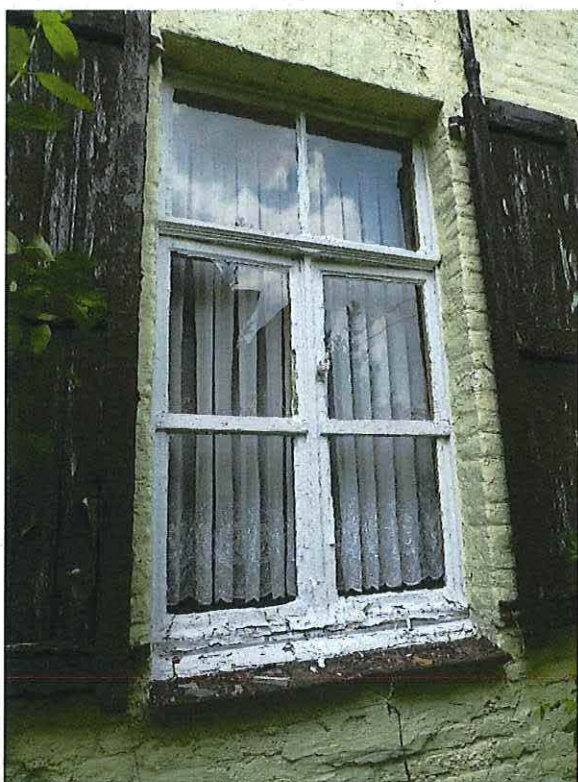
Foto 15: Boerenhuis, erfgevel, beluikt venster. Schade ten gevolge van vandalisme.
