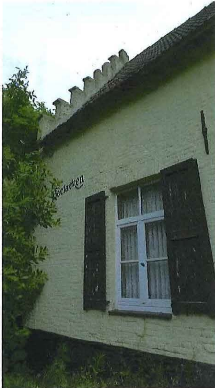
Foto 10: Boerenhuis, verankerde erfgevel. Detail van ontlastingsboog boven venster- toestand 18 juni 2015 met minder begroeiing
