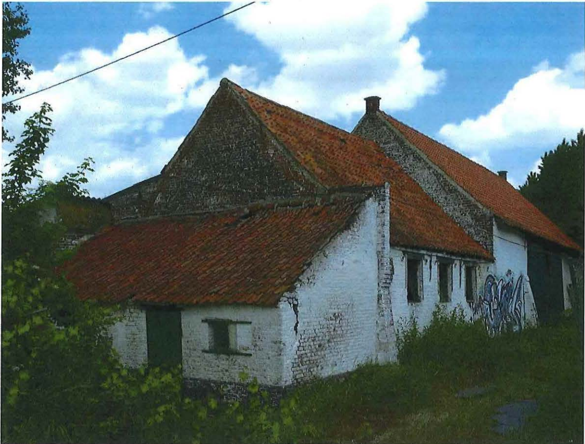
Foto 27: Dwarsschuur (zuidkant) met vooraan tweeledige stal, wagenhuis niet zichtbaar . Schade ten gevolge van vandalisme
