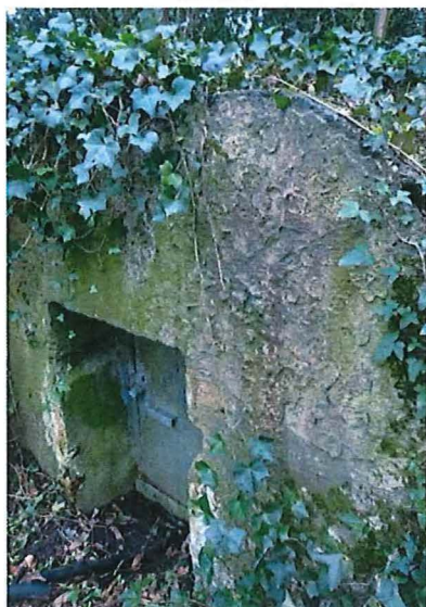
Foto 22: Betonspatten ter hoogte van de toegang. Foto genomen op 22 maart 2017.
