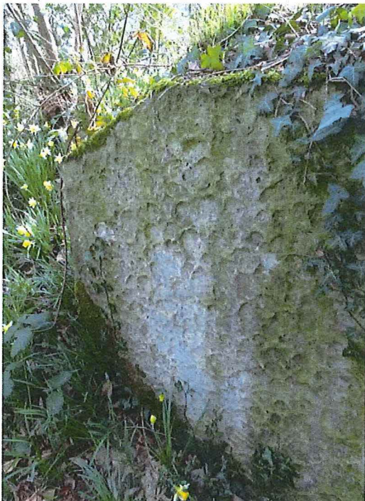
Foto 2: Detail van de betonspatten die tegen de achtergevel zijn aangebracht. Foto genomen op 17 maart 2017.
