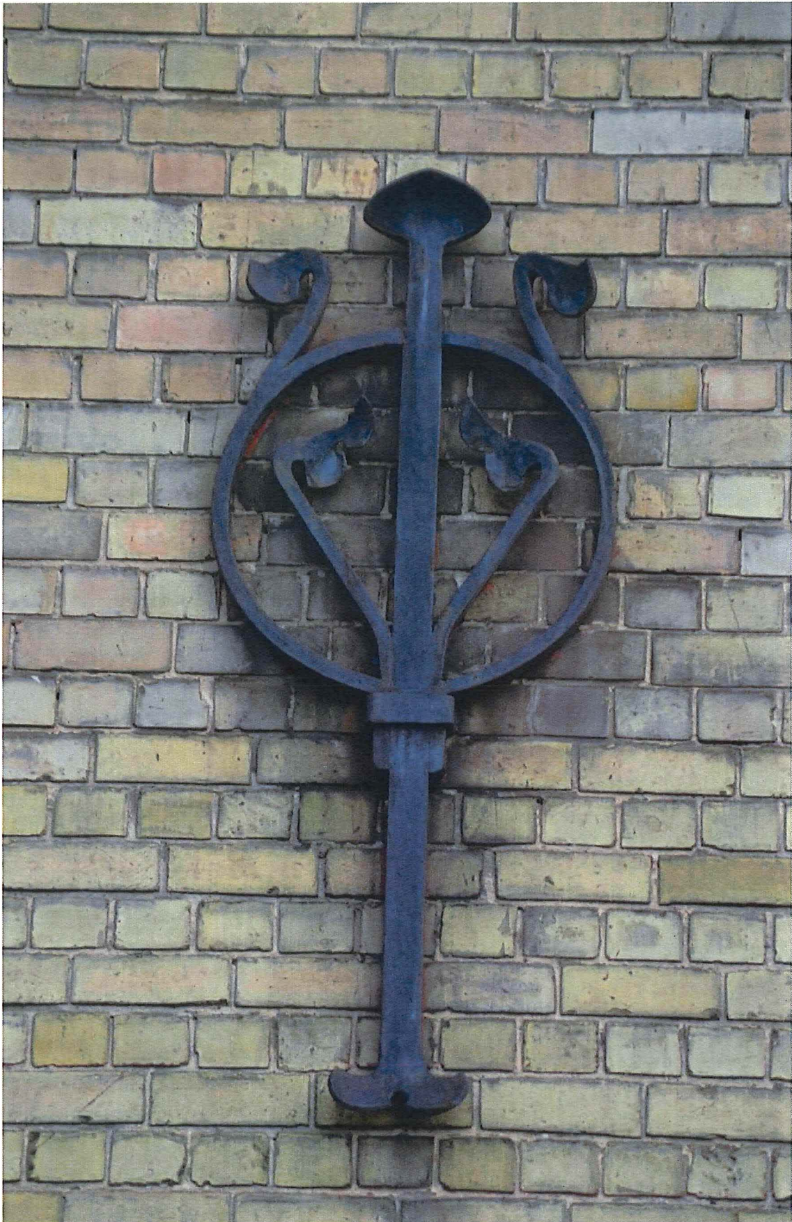
16. muuranker aan de voorgevel, 14/11/2017
