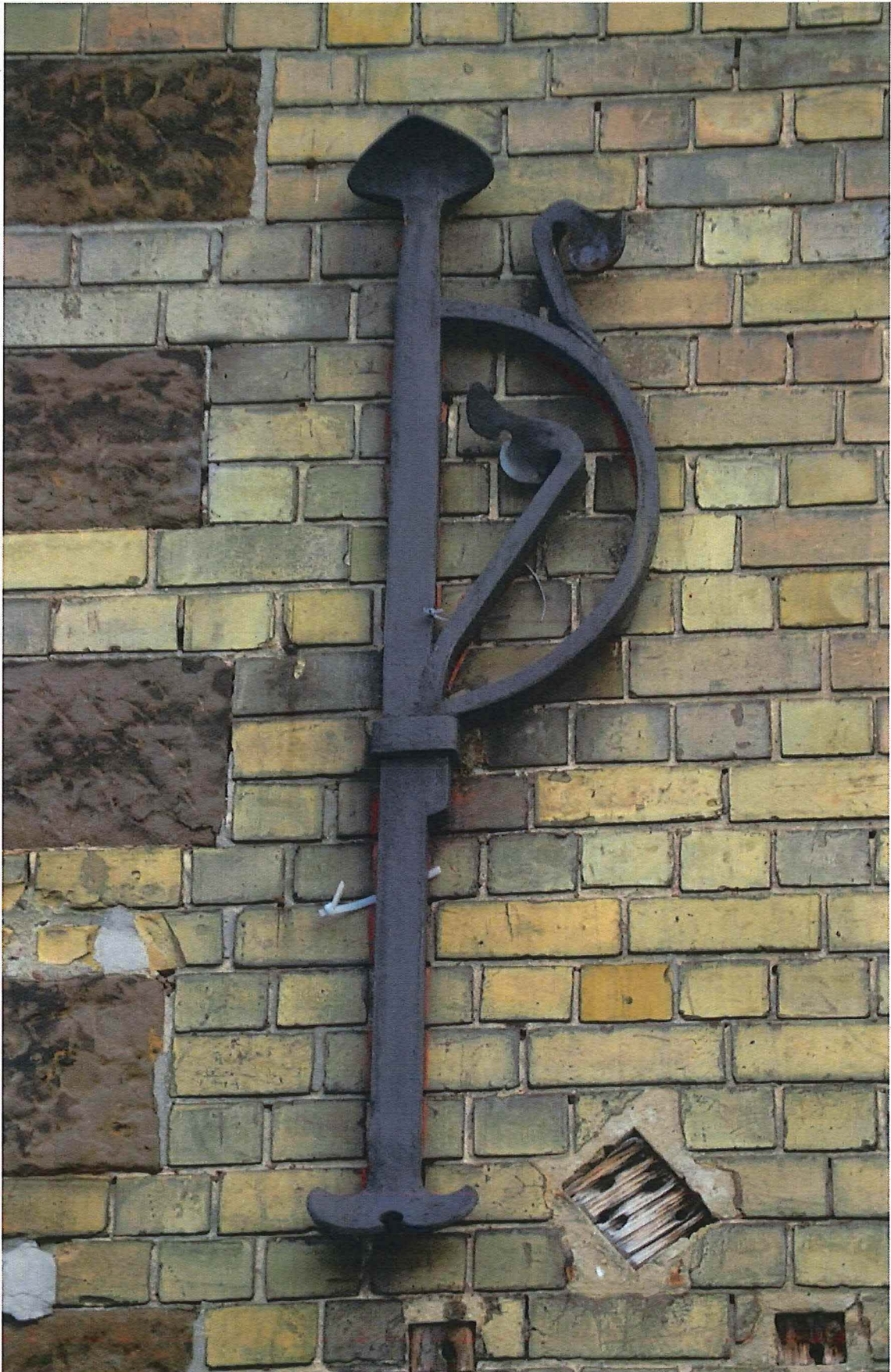
17. muuranker aan de voorgevel, 14/11/2017
