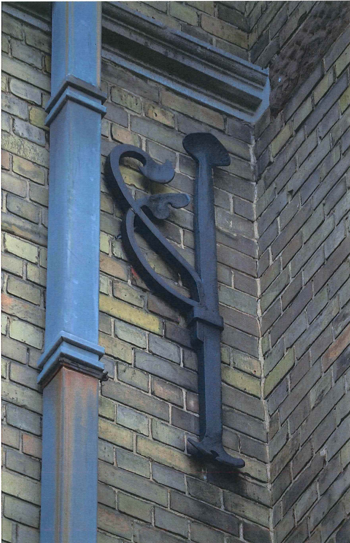
18. muuranker aan de voorgevel, 14/11/2017
