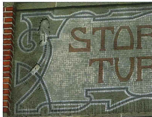
Foto 13: Vierde travee, detail schade mozaïekpaneel.
