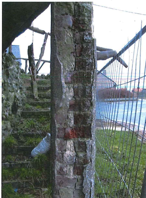
Foto 27: Scheurvorming van de kolommen (© Triconsult 07/02/2017).
