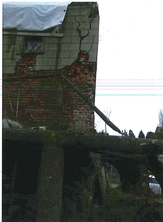
Foto 7: Verticale scheurvorming in de noordwestelijke hoek (© Triconsult 07/02/2017).
