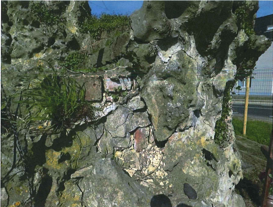
Foto 31: Detail rotseerwerk (© Bressers Architecten 22/11/2017).
