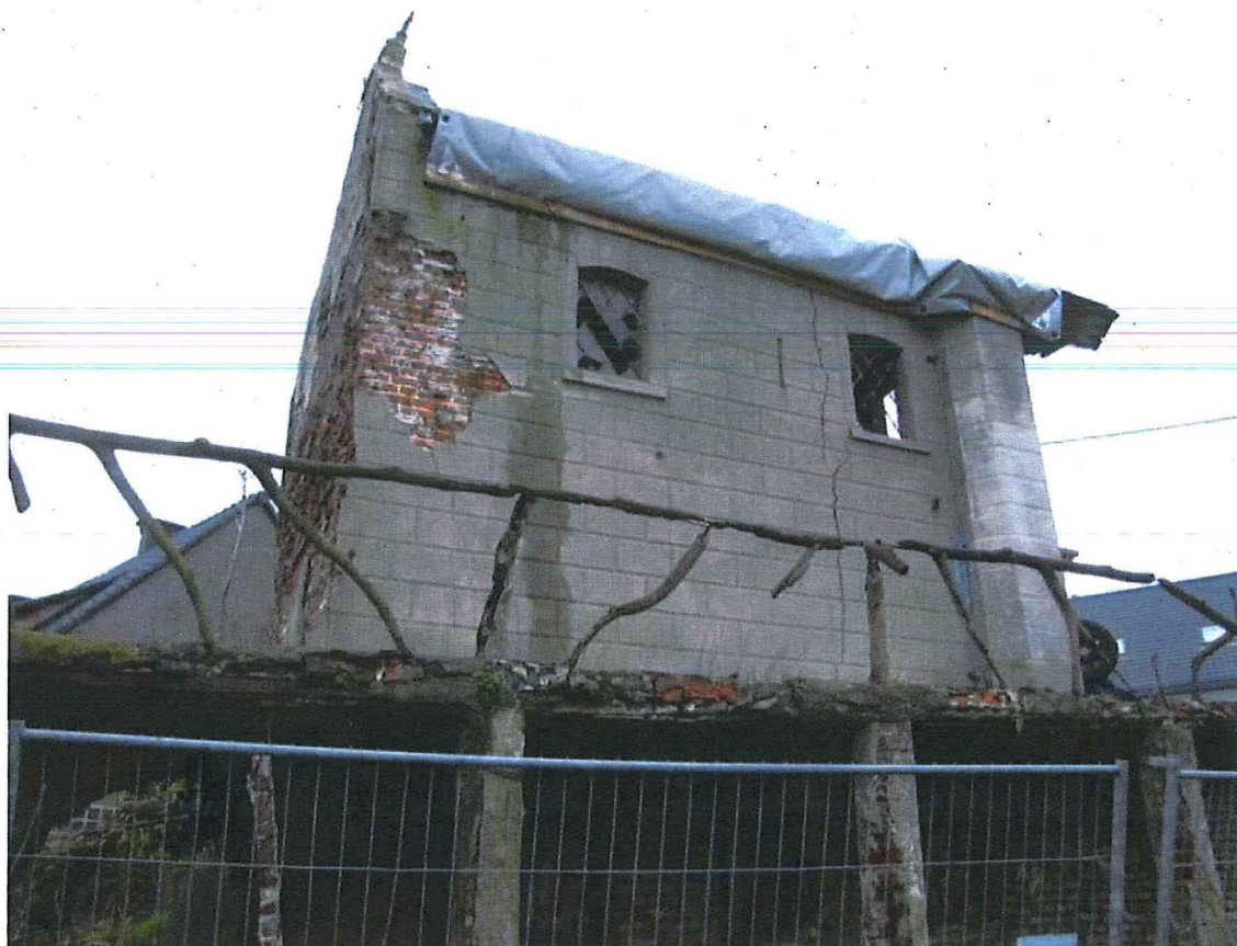
Foto 11: Zuidoostelijke zijgevel (© Triconsult 07/02/2017).
