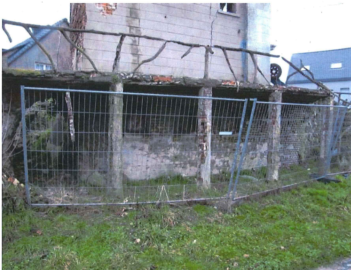
Foto 16: Zuidoostelijke zijgevel (© Triconsult 07/02/2017).
