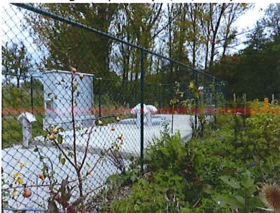
Foto 85: Technisch station hoek Hoofdstraat en Gieveldestraat (18/10/2016)
