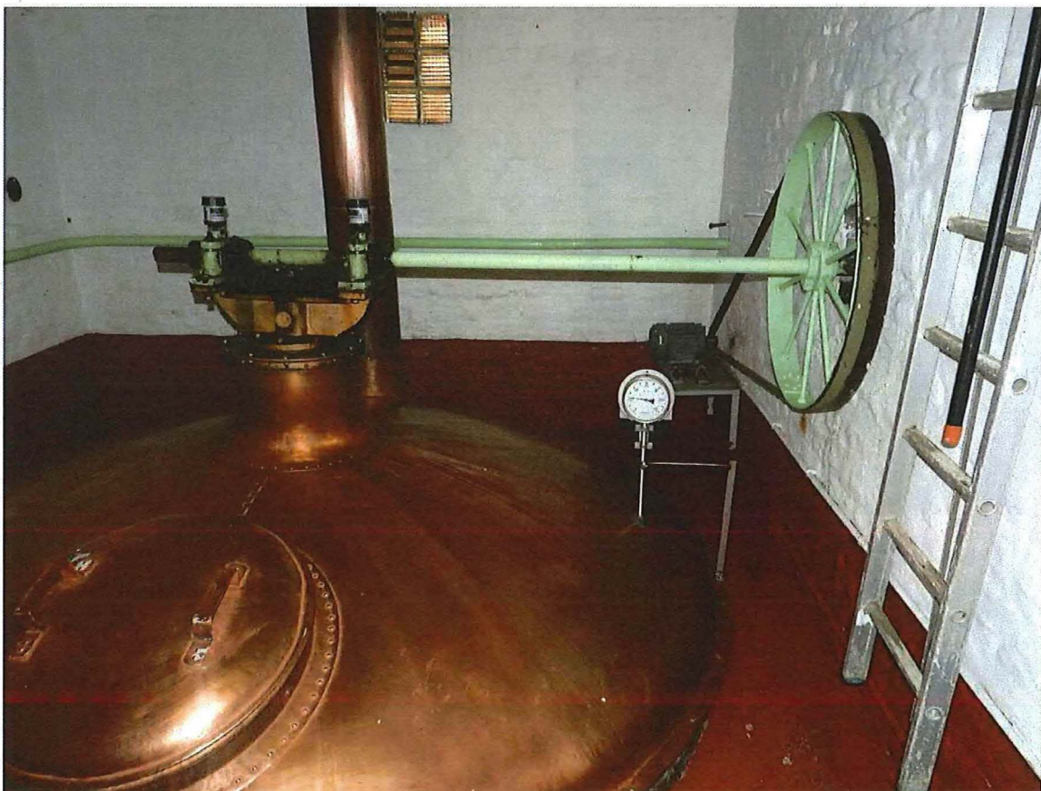
Foto 49: Interieur brouwerij, brouwzaal eerste verdieping, kookketel (08/05/2018).
