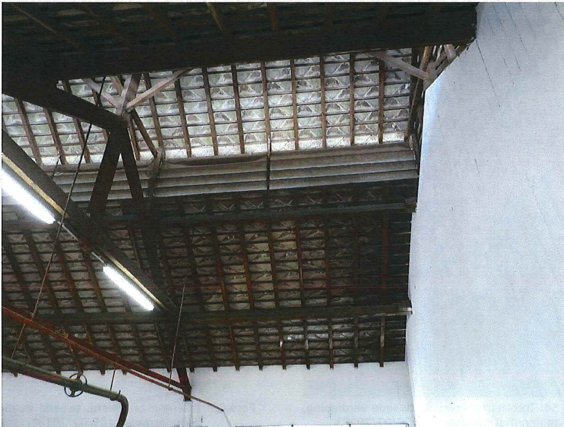
Foto 57: Interieur brouwerij, tweede verdieping, zoldering boven het koelschip met zicht op de ontdubbelde nok en de lamellen voor de afleiding van de dampen afkomstig van het koelschip, rechts de houten wand tussen de maalterij en het koelschip (08/05/2018).
