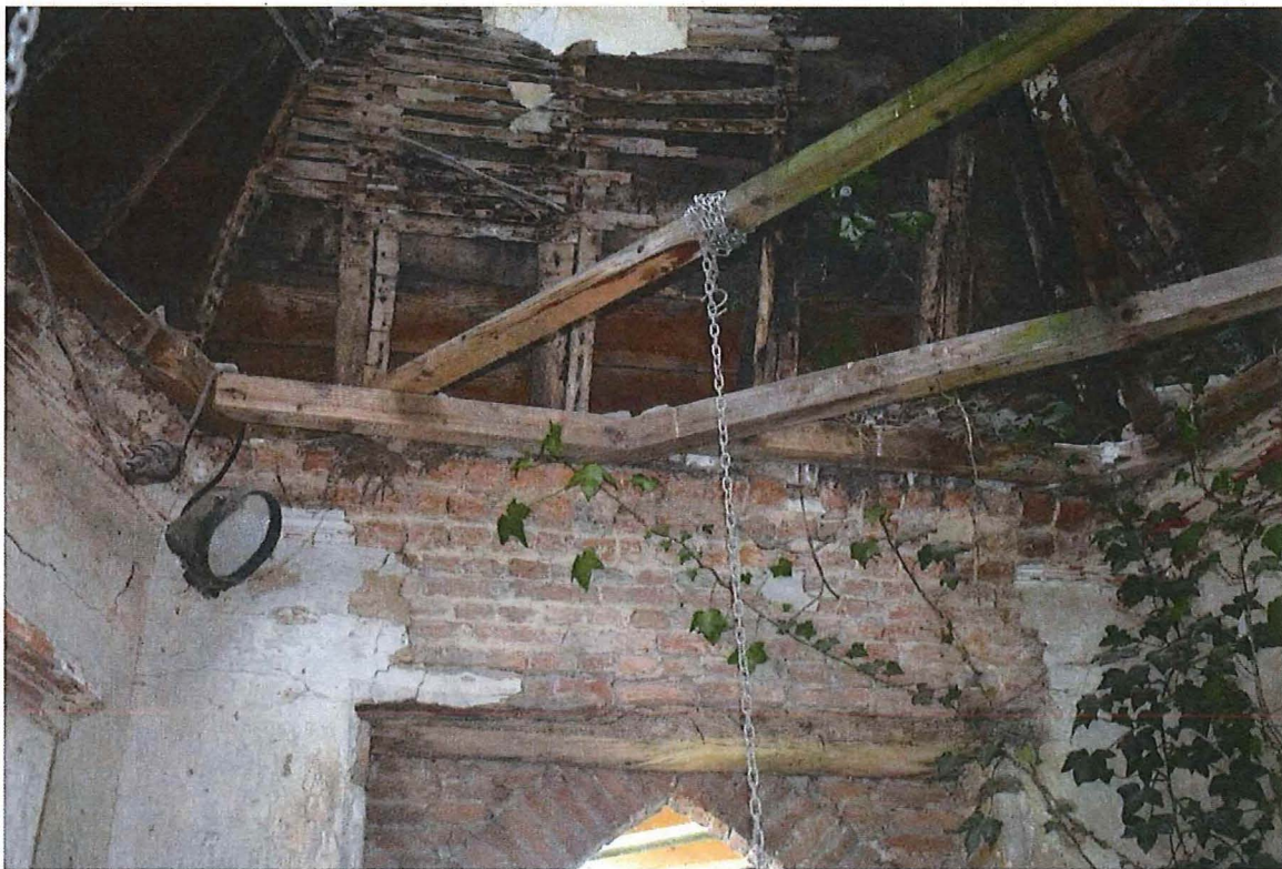
Foto 27: tuinpaviljoen: vervallen dakconstructie en fragmentarisch bewaarde binnenbepleistering
