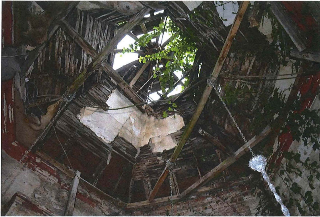
Foto 26: tuinpaviljoen: vervallen dakconstructie
