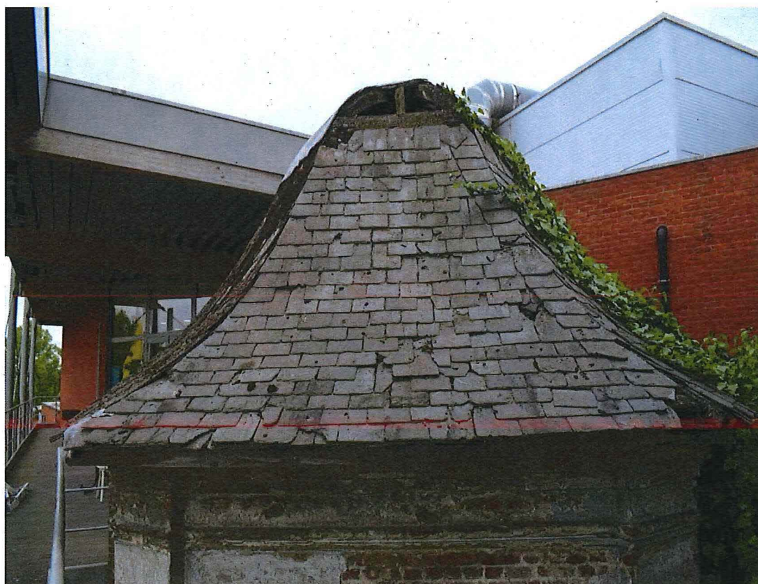
Foto 14: noord-oostzijde van de bedaking met natuurleien, ontbrekende bekleding van de top
