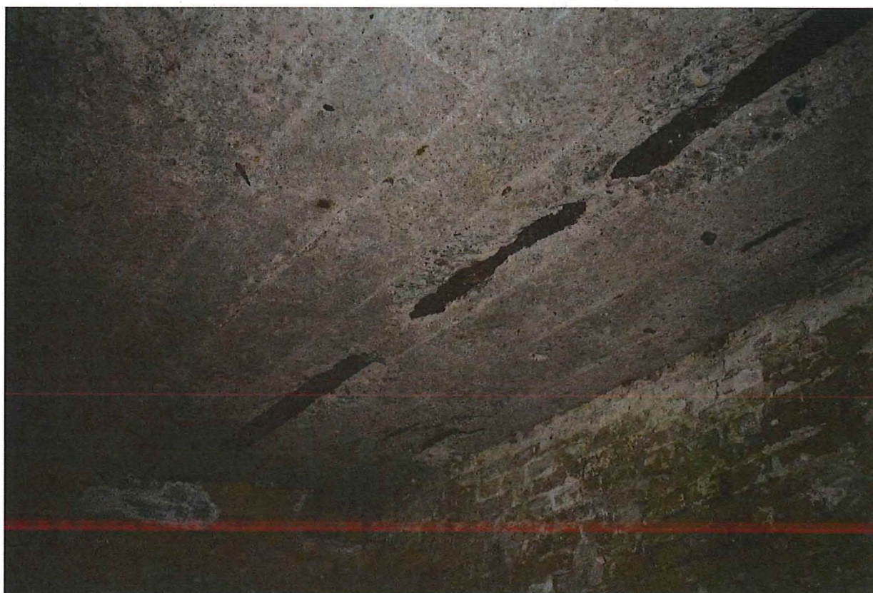
Foto 21: ijskelder: later ingebrachte betonplaat met betonrot
