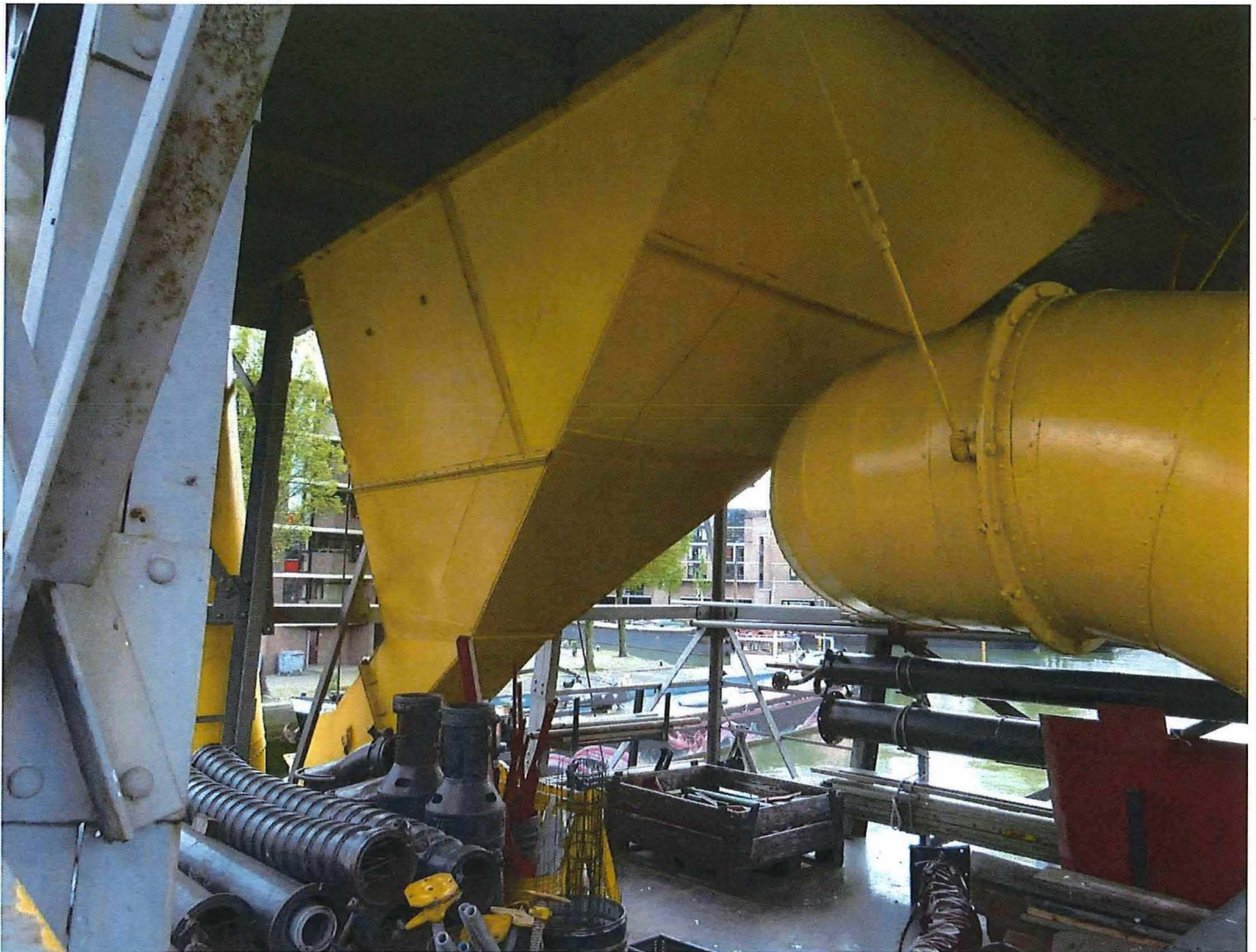
Foto 9: Het buizendek met links in het geel geschilderd de afstortpijp en rechts de buis met de afvoer van de lucht vanuit de vacuümpompen.
