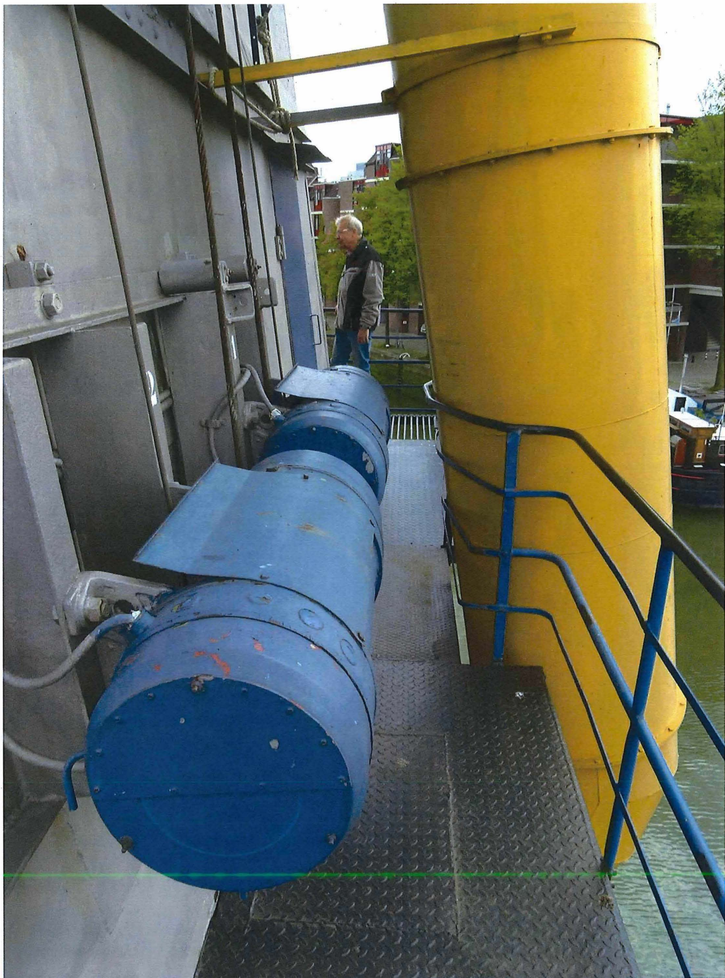
Foto 11: Het niveau van de weegkamer met twee van de in totaal vier elektrische lieren voor de bediening van de gieken.
