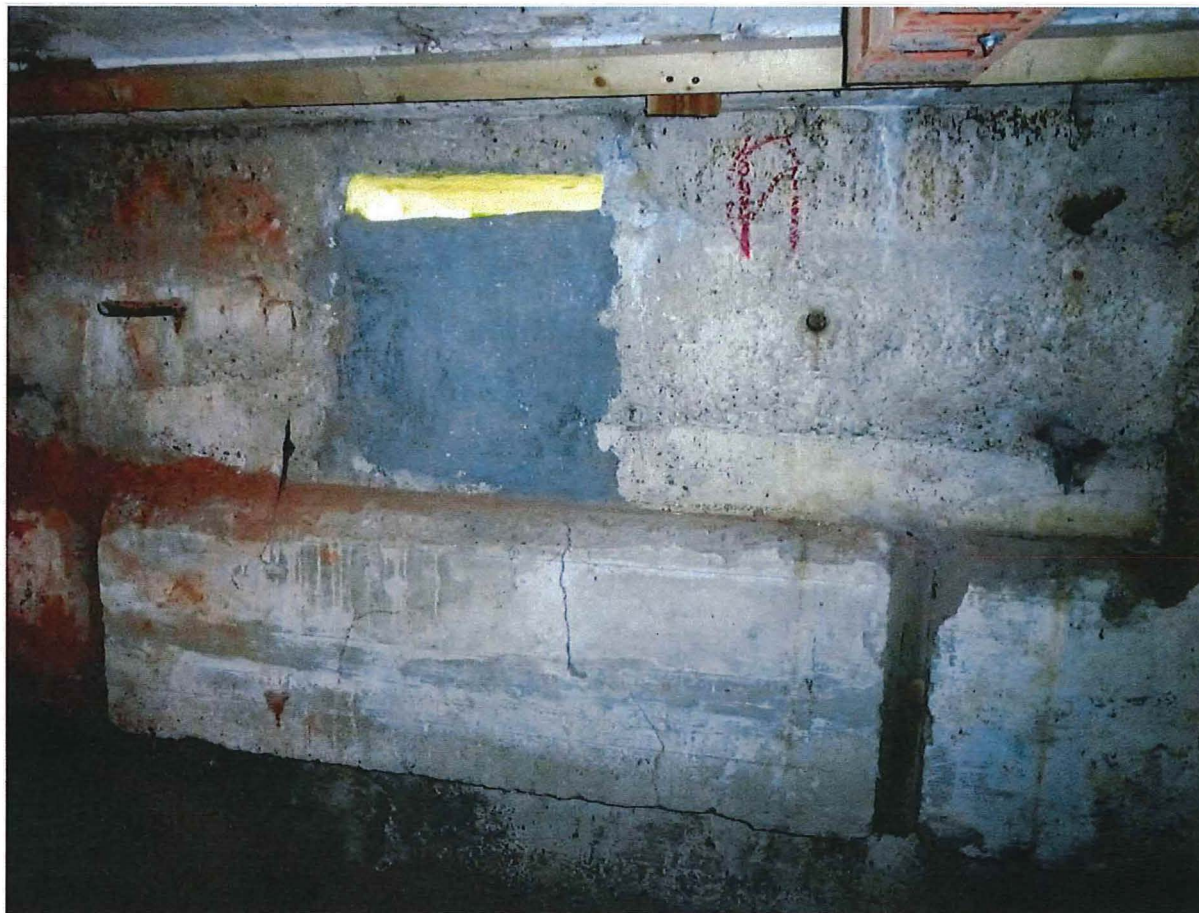
Foto 7: De schietopening aan oostelijke zijde is grotendeels dichtgemaakt.
