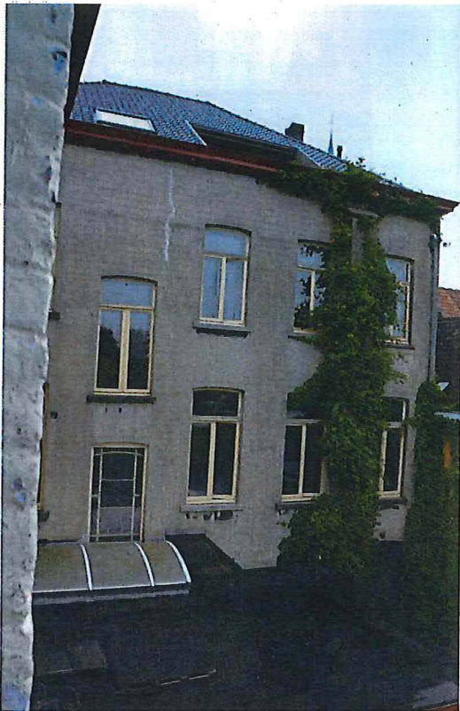
Foto 9: Achtergevel directeurswoning, gezien vanuit de achterbouw (30/08/2017).
