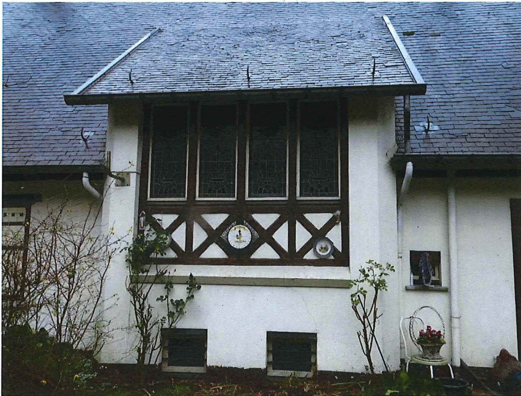
Foto 22: Achtergevel (zuidwesten), detail geveluitsprong onder lessenaarsdak. In het vierledig venster steken decoratief uitgewerkte glas-in-loodramen (4/01/2018).
