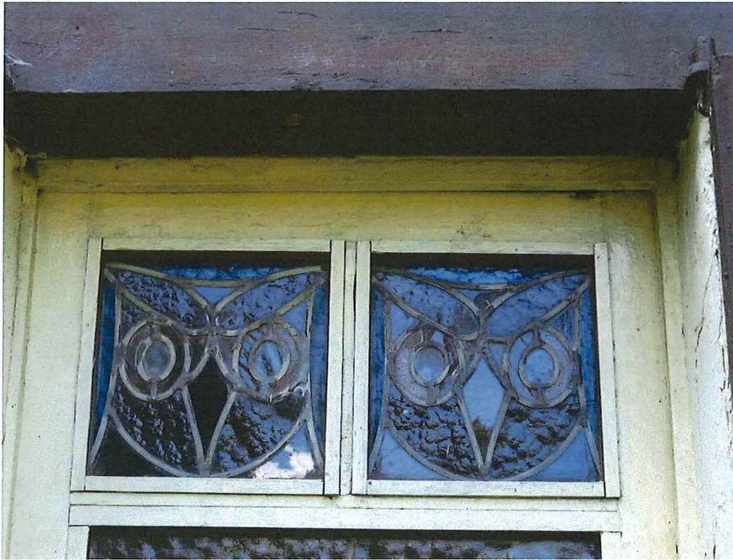
Foto 10: Detail klein rechthoekig venster in de voorgevel (noordoosten). In het bovenlicht steken decoratief uitgewerkte glas-in-loodramen met uilskopjes. Samengesteld glas in lood in vlak glas en reliëfglas. (19/09/2018).
