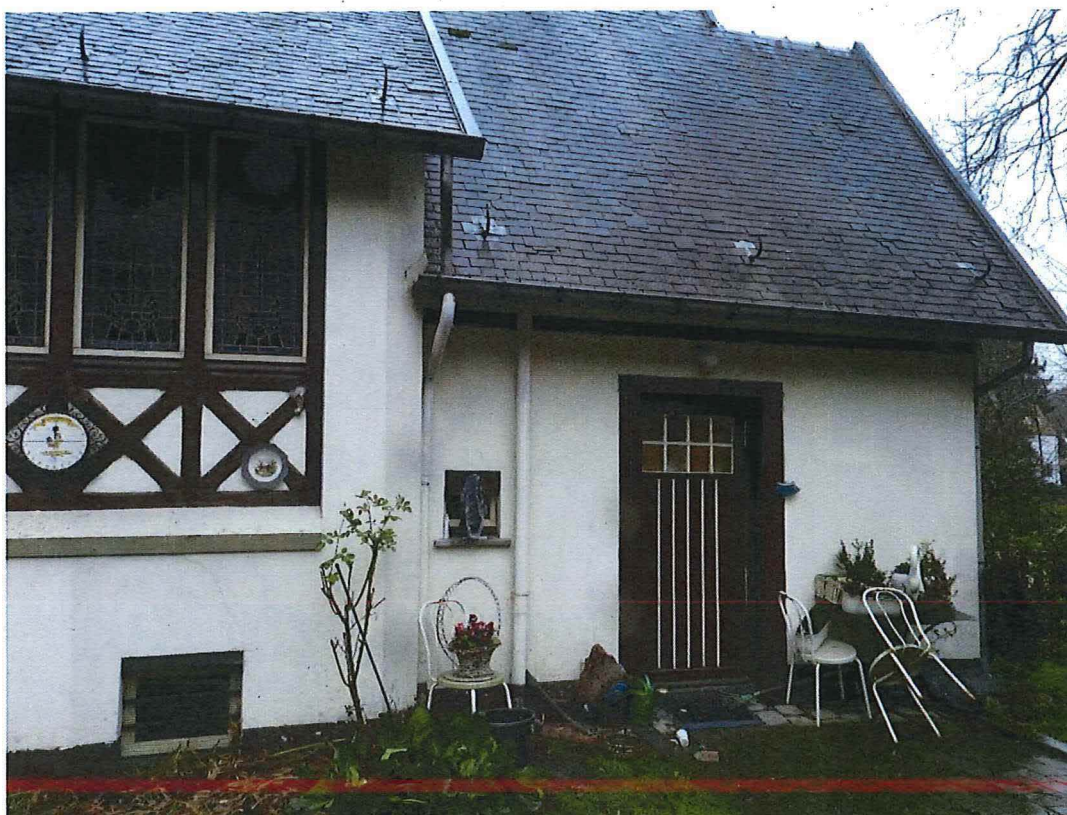
Foto 21: Detail achtergevel (zuidwesten) Villa Herman Teirlinck. De achterdeur betreft een enkele opgeklampte deur met bovenlicht. Deze geeft toegang tot de keuken (4/01/2018).
