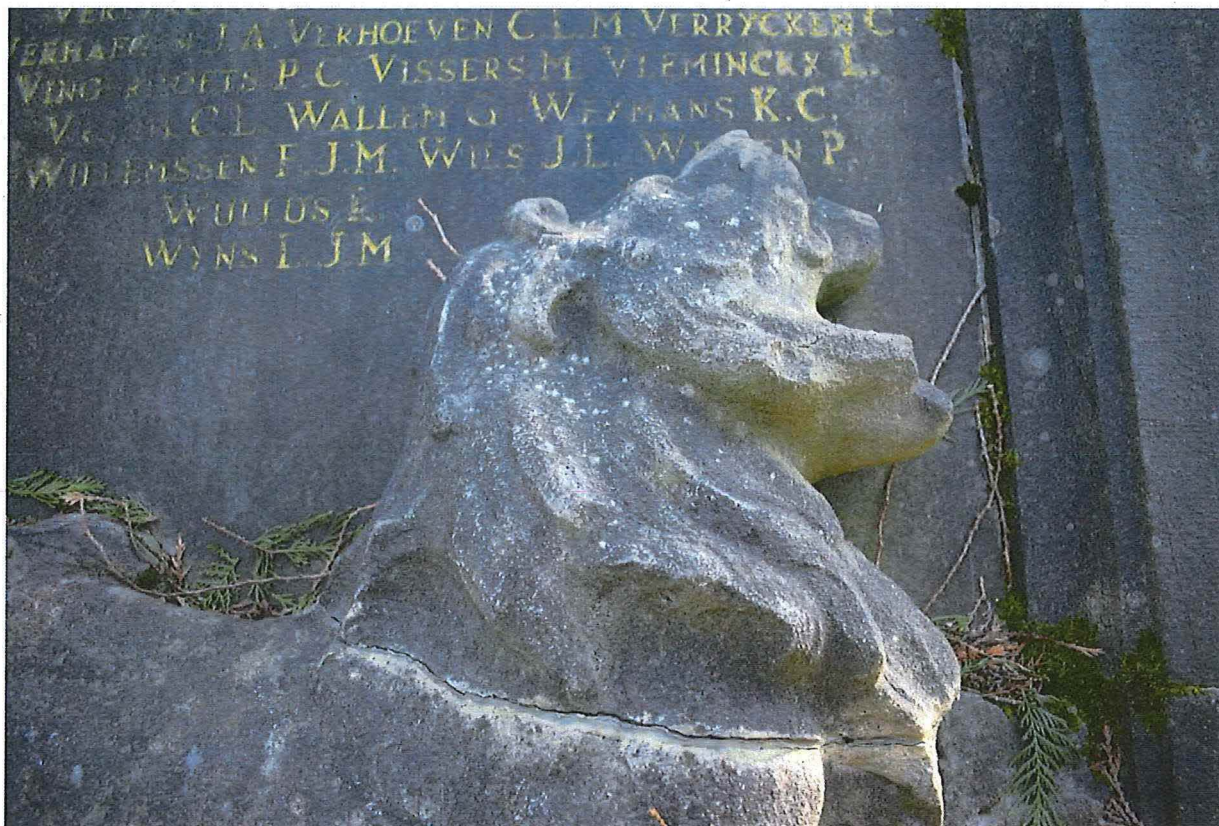
Foto 8: detail leeuwenkop met zichtbare (eertijds ondeskundig herstel) barst
