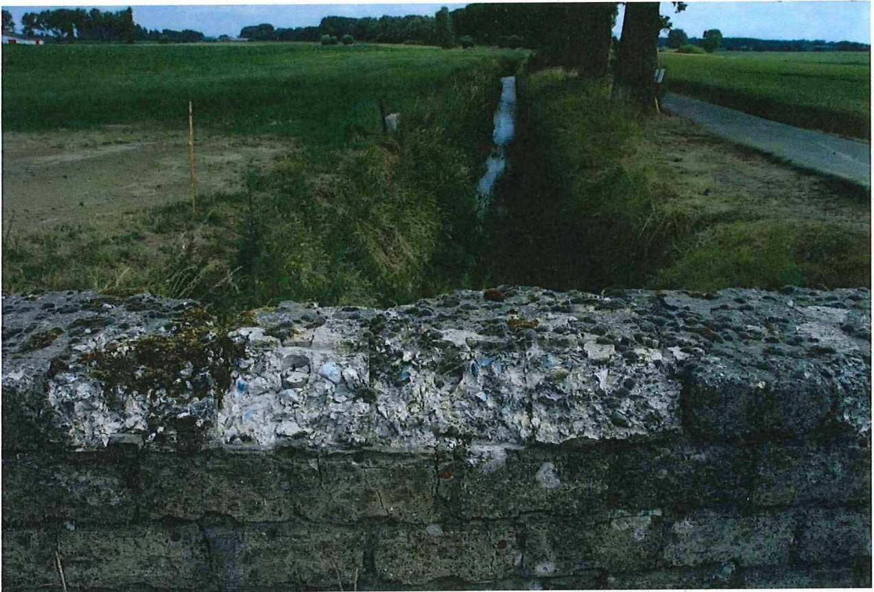
Foto 5: Beschadigde betonstenen bovenop de noordoostelijke borstwering.
