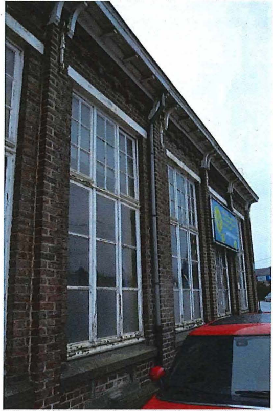
Foto 9: Detail raampartijen voorgevel. Ter hoogte van de lisenen bevinden zich de consoles van de dakoversteek (13/12/2017).
