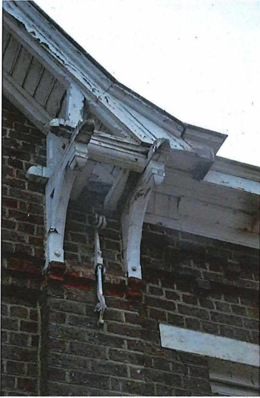
Foto 8: Detail dakoversteken en consoles ter hoogte van de puntgevel (13/12/2017).
