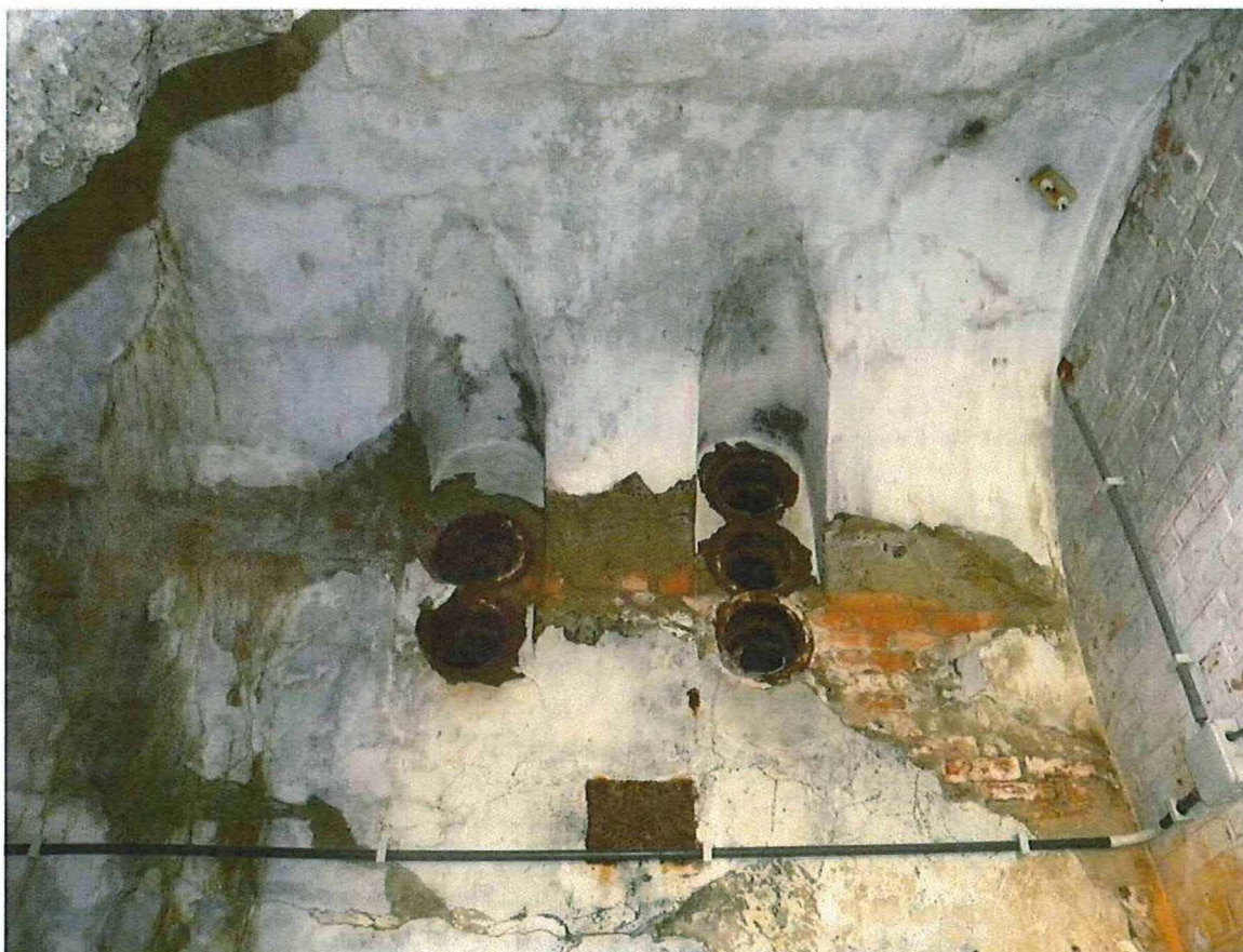
31. Hoofdfrontgebouw, rechts, ventilatiegaten aangesloten op het systeem dat in oorlogstijd in overdruk kon worden geplaatst om giftige explosiedampen naar buiten te drijven, 12/05/2017.
