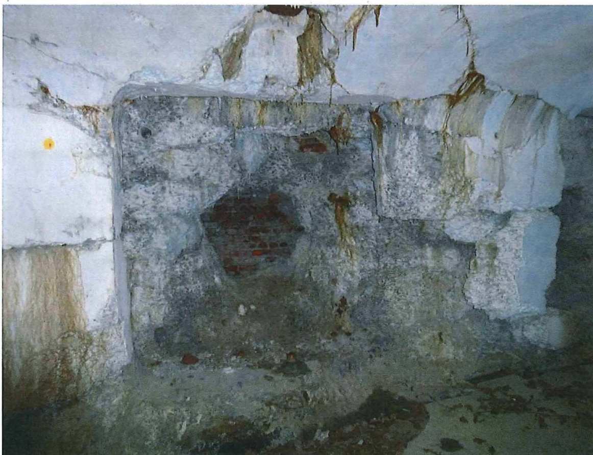
48. Caponnière rechts, schade veroorzaakt door het verwijderen van de metalen plaataffuit in de wand, 22/05/2016.
