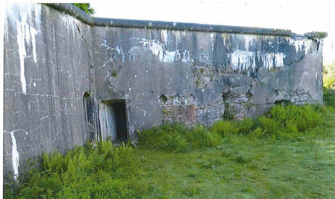
45. Caponnière links, met beschadigingen aan de buitengevel als gevolg van het verwijderen van de metalen plaataffuiten tijdens de Tweede Wereldoorlog, 22/05/2017.
