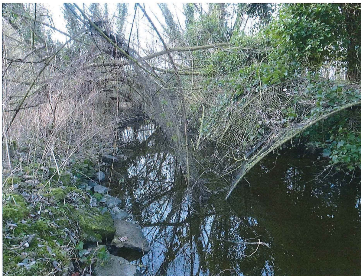
Foto 8: Beschadigde zuidelijke vangpijp 4 met steenbestorting op rechteroever (Bornem)
