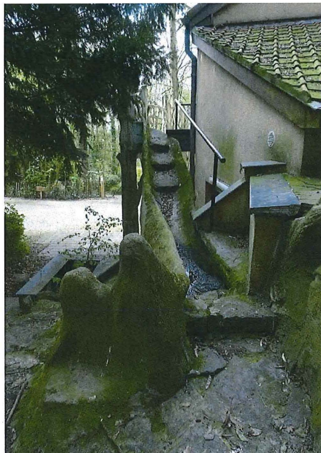
foto 34: detail geëvoeerde omgevallen boom uitgewerkt als afvoergoot
