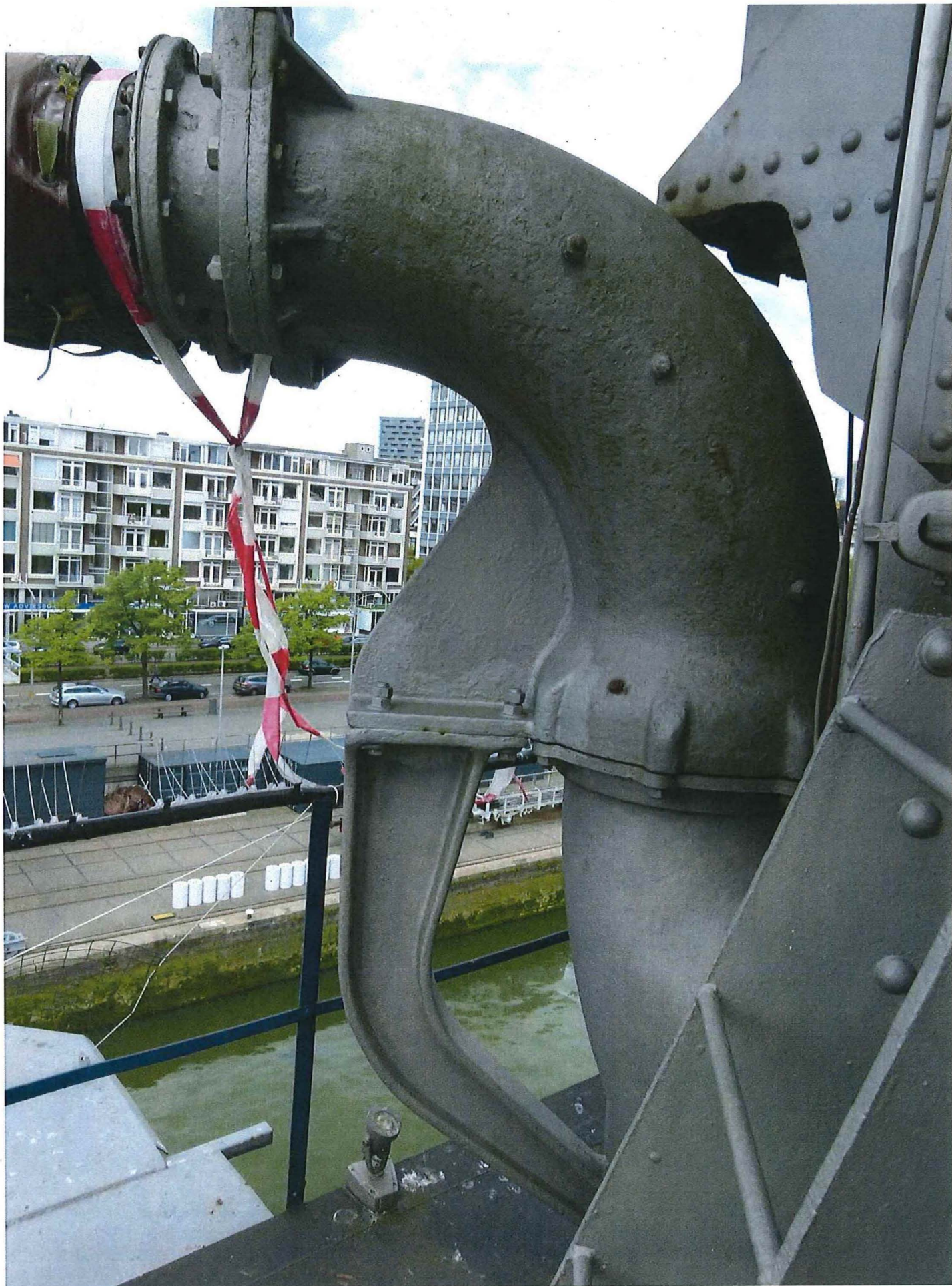
Foto 18: De aansluiting van één van de vier graanzuigleidingen op de recipiënt.
