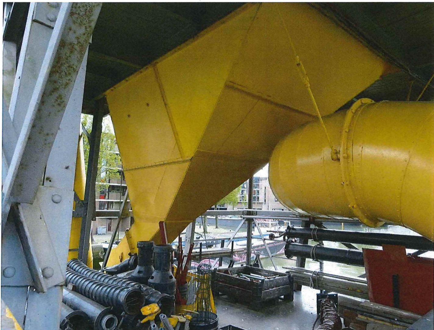
Foto 9: Het buizendek met links in het geel geschilderd de afstortpijp en rechts de buis met de afvoer van de lucht vanuit de vacuümpompen.
