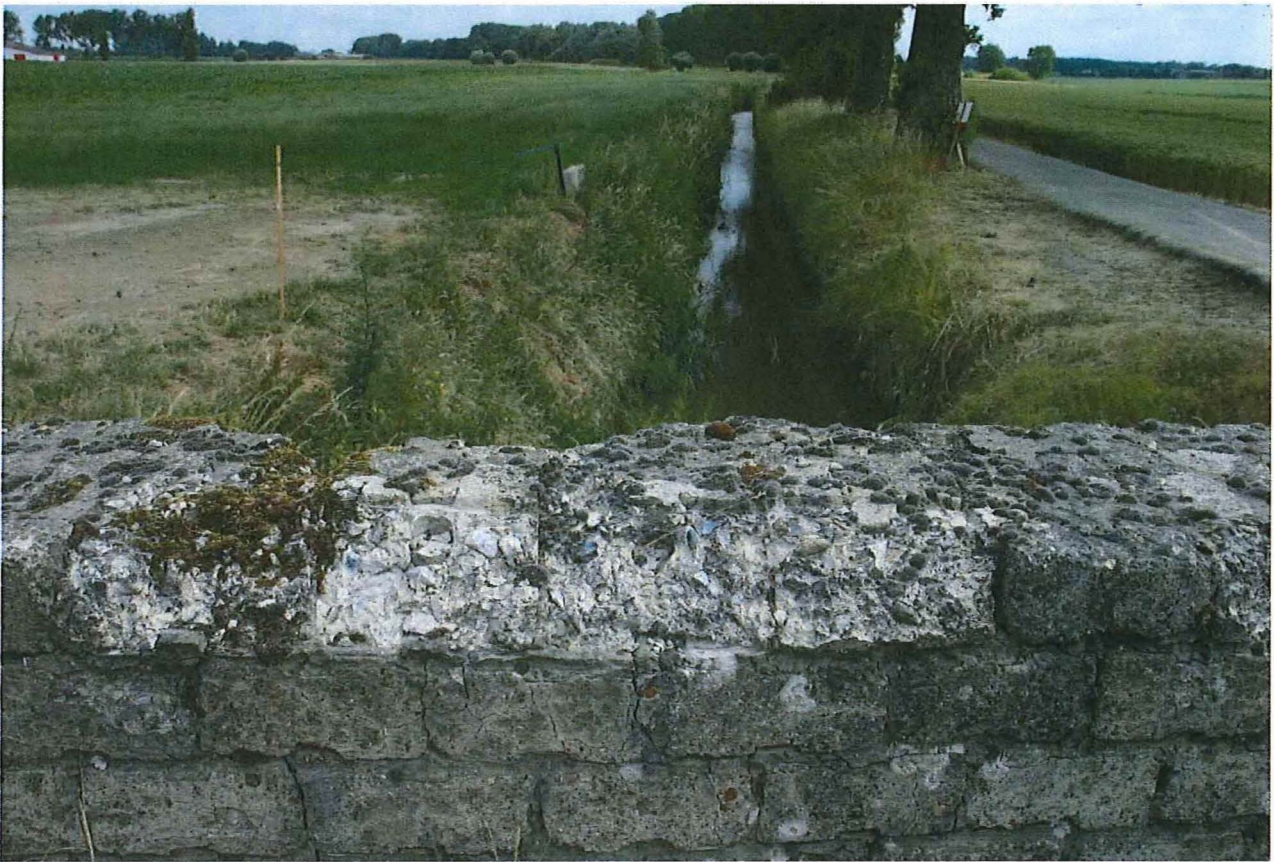
Foto 5: Beschadigde betonstenen bovenop de noordoostelijke borstwering.
