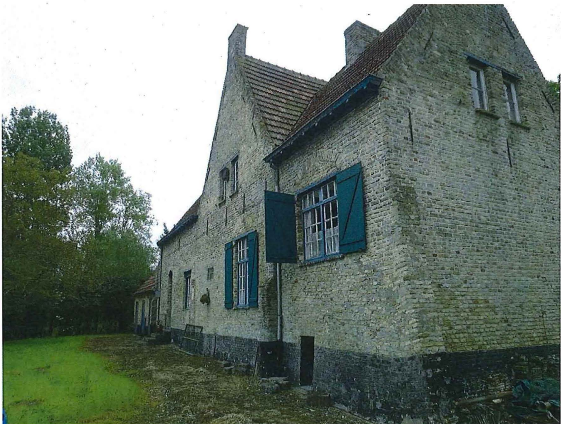
Foto 17. De achtergevel (oostgevel) van het boerenhuis gezien vanaf de noordelijke zijgevel. Rechts, het bewaarde oorspronkelijk houtwerk van de opkamer.
