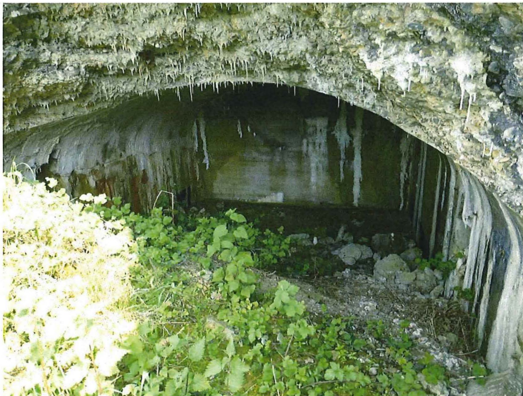
23. Oorlogsschade uit 1914 aan het rechterhoofdfrontgebouw, de getroffen kamers zijn met een betonnen muurtje aan de binnenzijde afgesloten, de doorboorde gewelven tonen een vrij groffe structuur van beton met grind, 21/05/2016.
