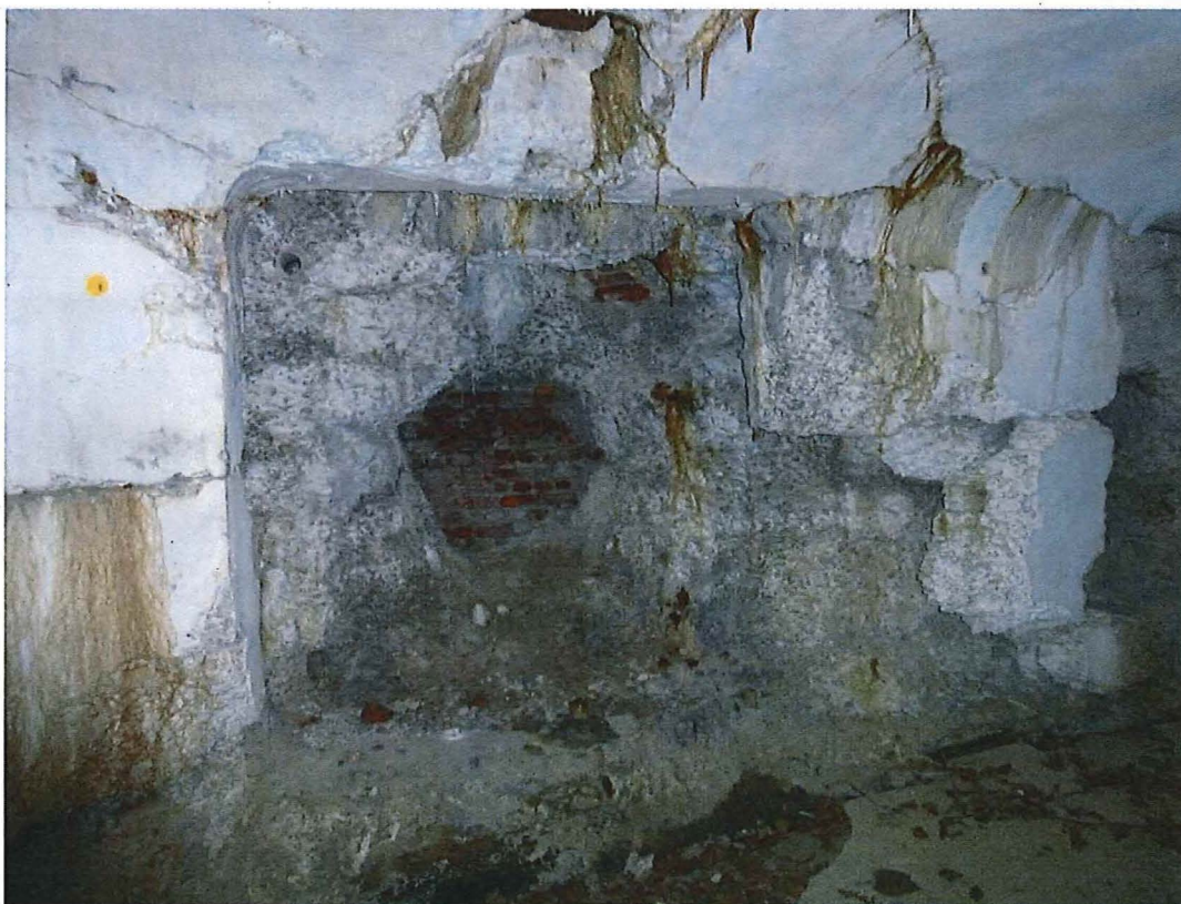
48. Caponnière rechts, schade veroorzaakt door het verwijderen van de metalen plaatfuit in de wand, 22/05/2016.
