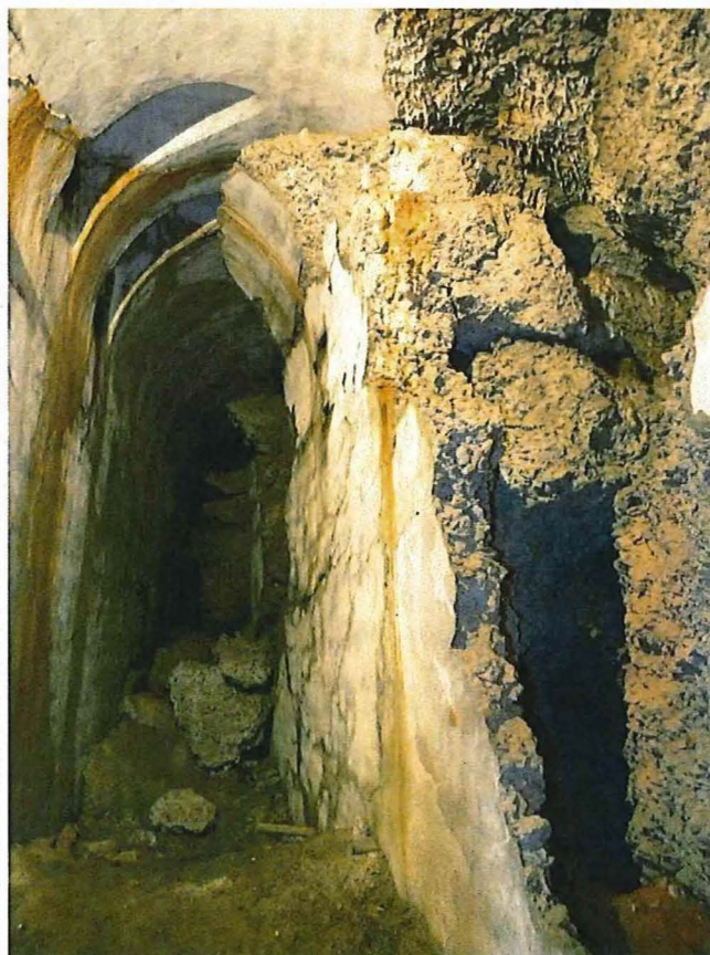
14. Rechterkeelfrontgebouw Gang. Oorlogsschade. Op 3 oktober 1914 deed een inslaand projectiel op de aanaarding van het keelfrontgebouw de buitenzijde van de muur naar binnen schuiven. Ongeveer 6m van de gang in het rechterkeelfrontgebouw is niet meer toegankelijk. Het deel is met een gemetselde muur afgesloten. De toegang tot de rest van het rechterkeelfront verloopt sindsdien via de machinekamer, 22/5/2016.
