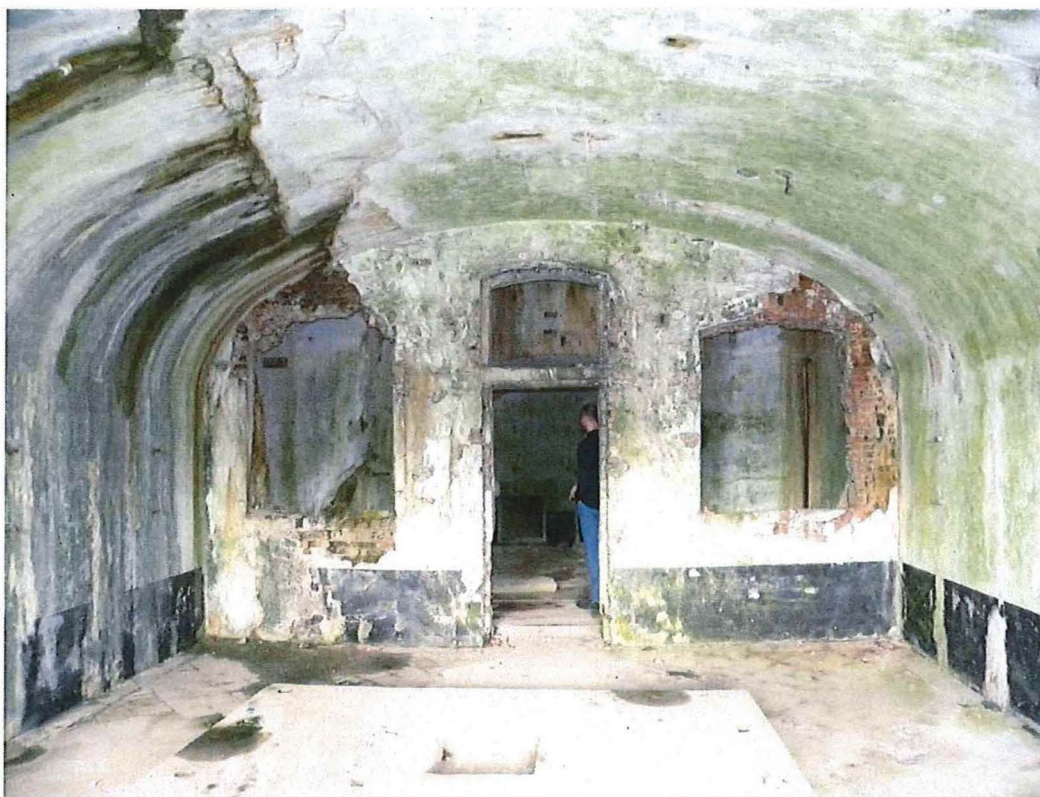
17. Keelfrontgebouw (links), interieur: douchekamer, met cementtegels, de douche-installatie en kranen zijn verwijderd, 22/5/2017.
