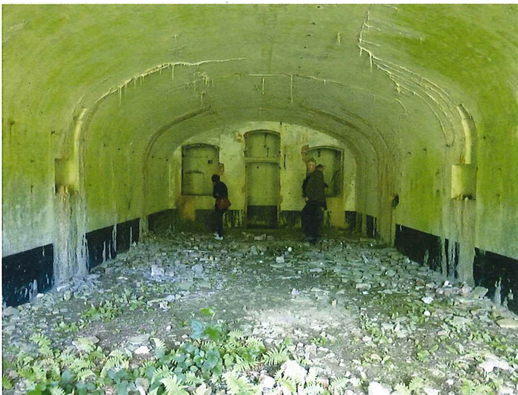
25. Rechterhoofdfrontgebouw, niet beschadigde kamer, zicht op de binnenmuur, 22/05/2017.
