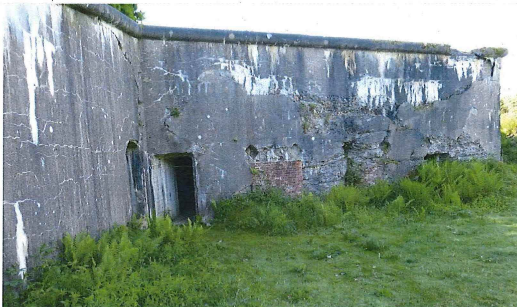
45. Caponnière links, met beschadigingen aan de buitengevel als gevolg van het verwijderen van de metalen plataffuiten tijdens de Tweede Wereldoorlog, 22/05/2017.
