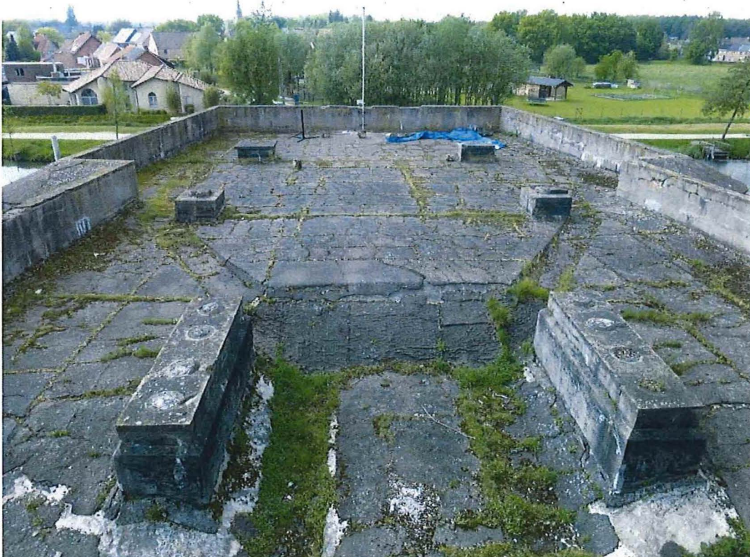
10. Het dak van de traditorebatterij met borstwering, ventilatiegaten en de toegang vanuit de centrale verbinding tussen keelfront en hoofdfrontgebouw. De dakbedekking bestaat uit een gegoten asfaltlaag die erg verbrokkeld is, 12/05/2017.
