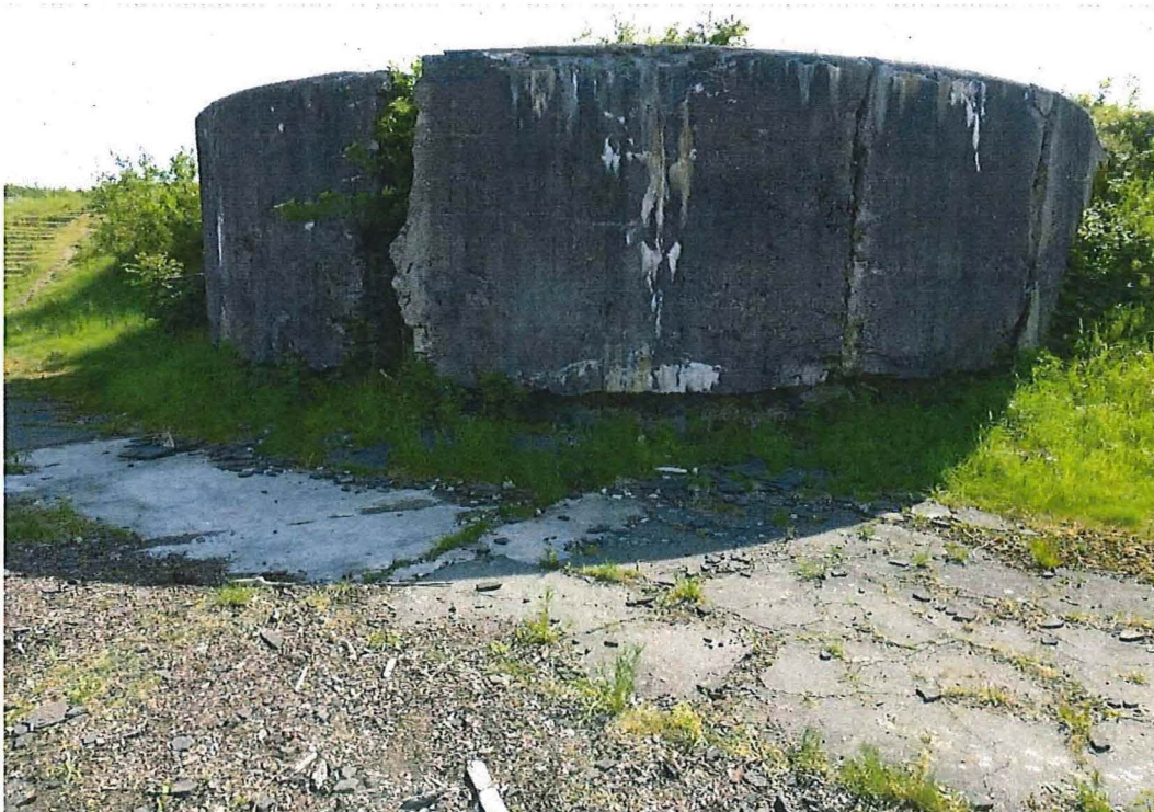
34. 12cm geschutskoepel (rechts), achterzijde: de verticale barst vergroot door vorstschade, 22/05/2017.
