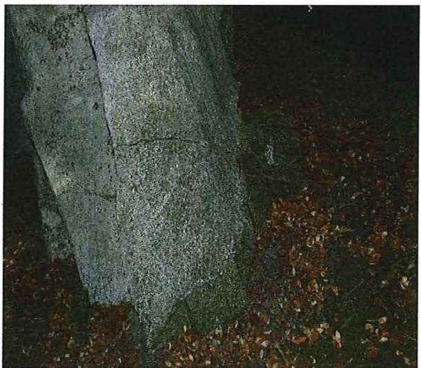
Foto 75: Kruisweg: detail: ter hoogte van het maaiveld zichtbaar verschil tussen de oudere en latere afwerkingslaag met cementpleister
