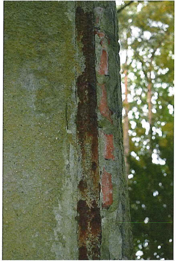
Foto 23: openluchtpreekstoel: achterzijde: schade door corroderende wapening
