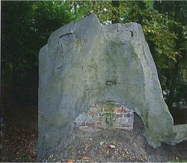
Foto 51: Zeven Weeënweg: achterzijde in slechte staat: afgescheurde cementpleister, zichtbare bakstenen kernstructuur
