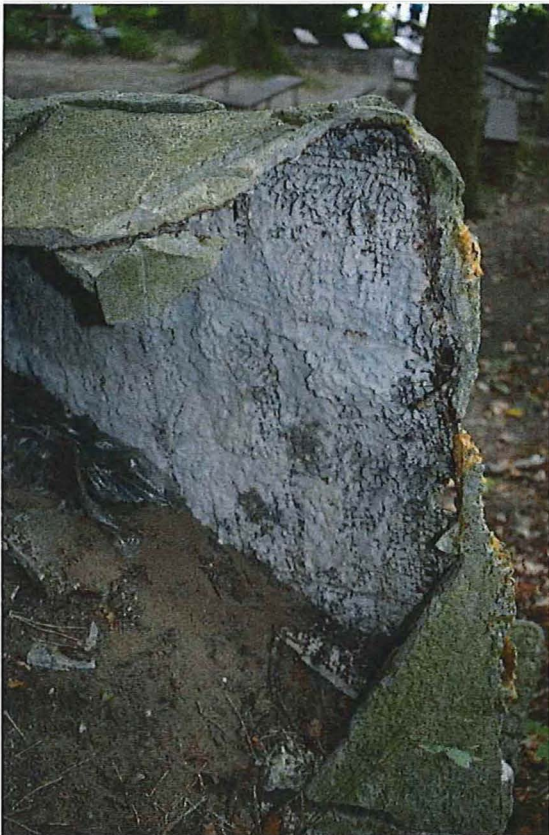
Foto 53: Zeven Weeënweg: achterzijde in slechte staat: zicht op metalen frame en netwapening met cementpleister
