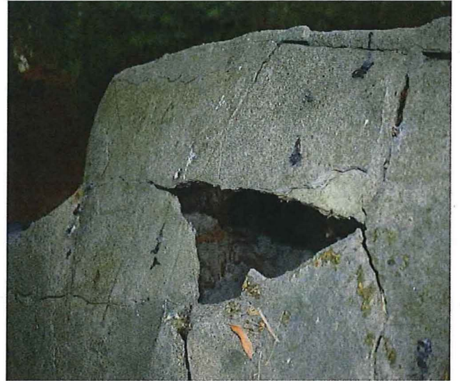
Foto 52: Zeven Weeënweg: achterzijde in slechte staat: detail afgescheurde cementpleister
