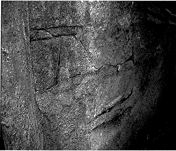
Foto 29: schuilhut: achtergevel: schade door corroderende wapening
