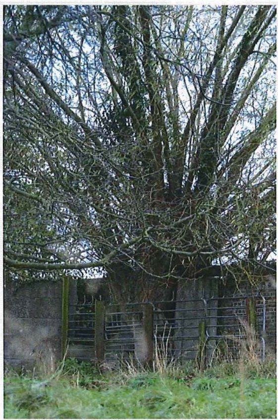
Foto 19: De westelijke omheiningsmuur ondervindt schade van een knotwilg
