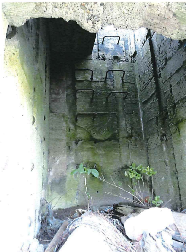
Foto 7: Klimijzers in het mangat.
