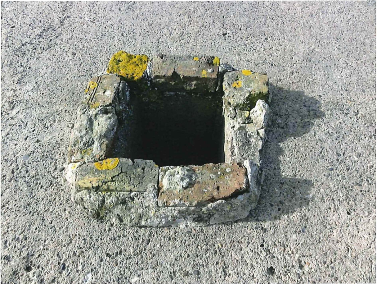
Foto 7: Bakstenen rond de opening in het dak.
