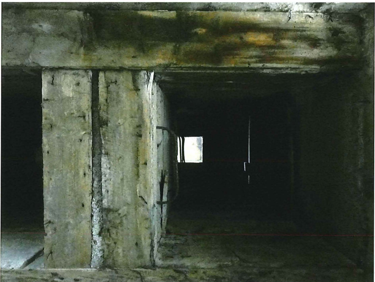
Foto 8: De mangaten met klimijzers.
