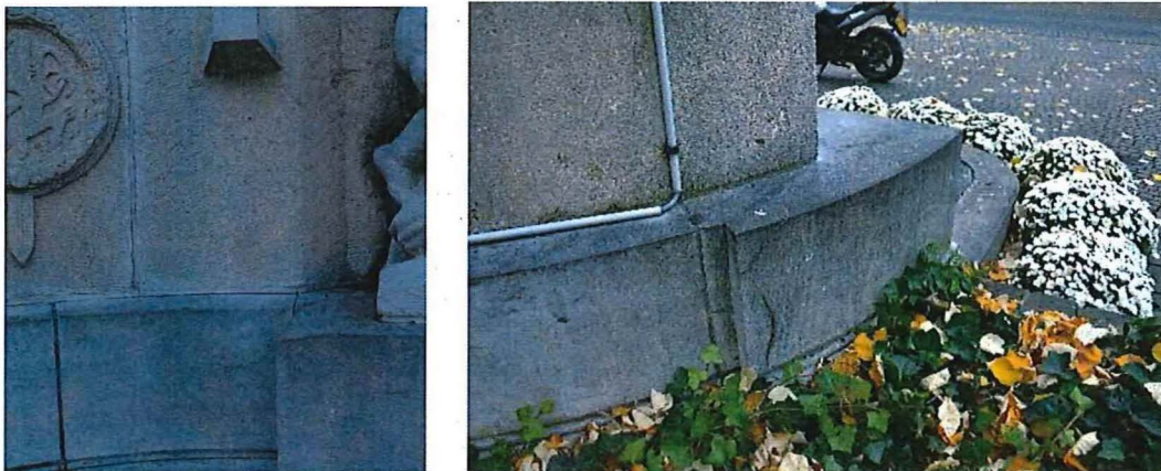
Fig. 16 en 17: Schade aan de voegen, 2016
