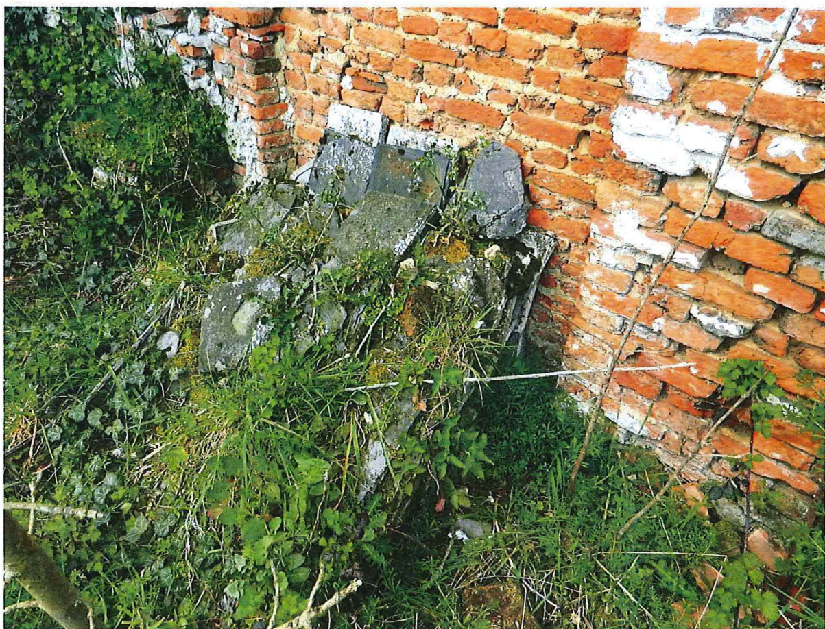
Foto 20: stapel dakleien tegen de noordmuur van de vroegere zuidvleugel.
