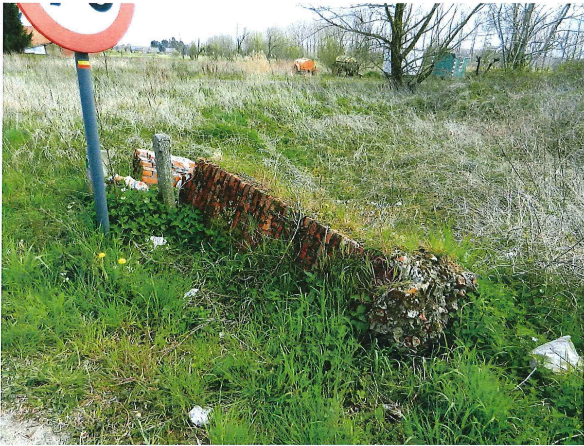
Foto 19: omgevallen oostelijke pijler van de poort aan de Heirweg.
