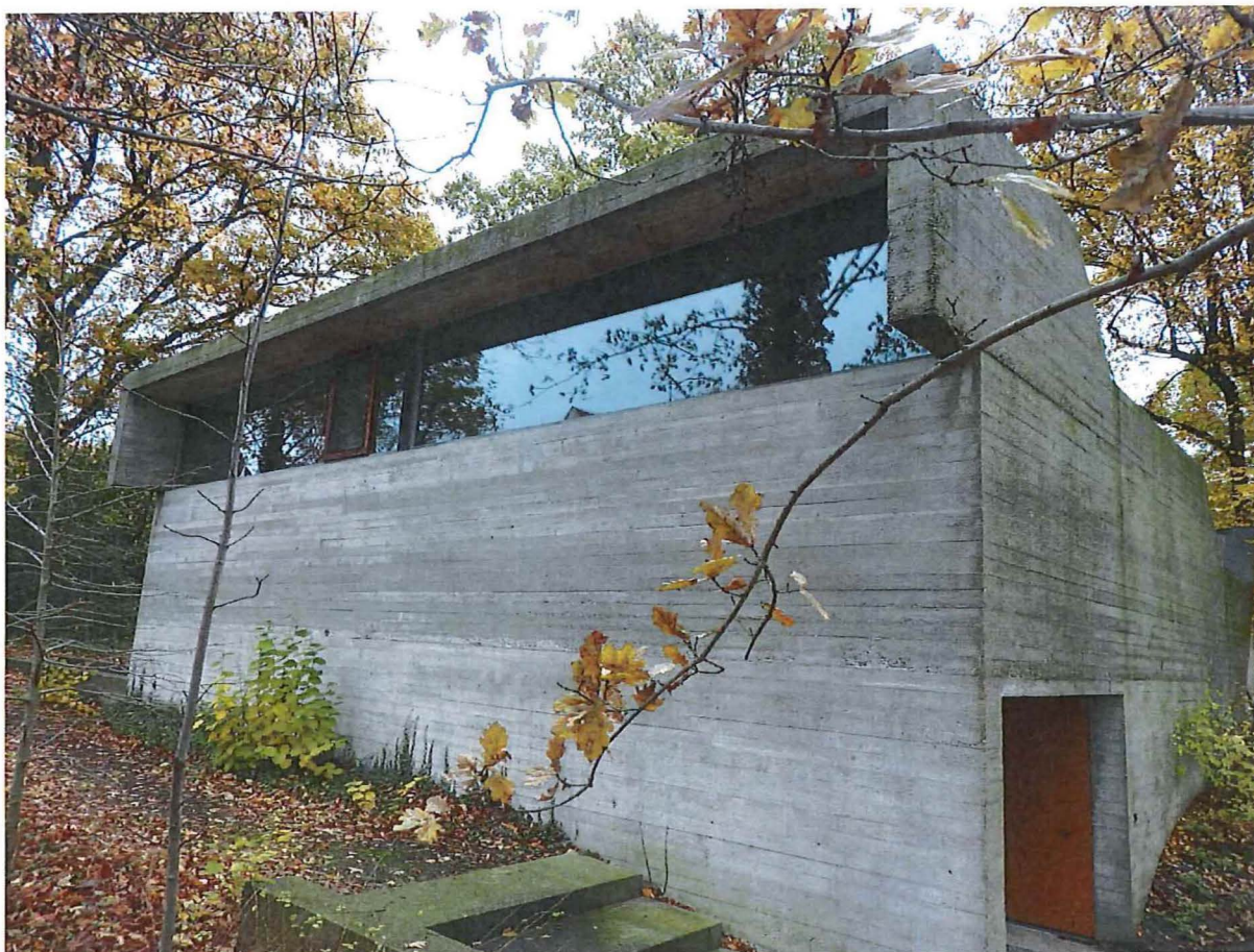
Foto 9: Woning Van Wassenhove. Westgevel met overluid bandraam.
