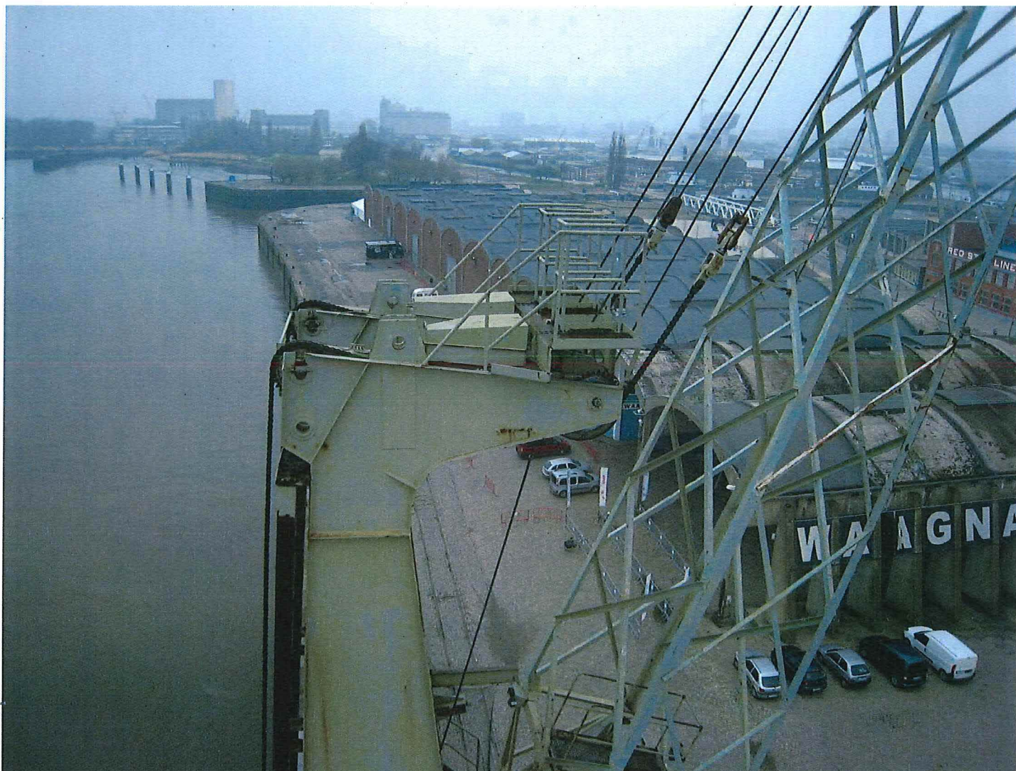
Foto 37: Bovenaan de toren zijn de twee kettingwielen geïnstalleerd die de twee rollenkettingen van het tegengewicht van de giek geleiden en de twee schijven voor de geleiding van de hijskabel. Alle kettingwielen en schijven zijn bereikbaar voor onderhoud vanop een platform.
