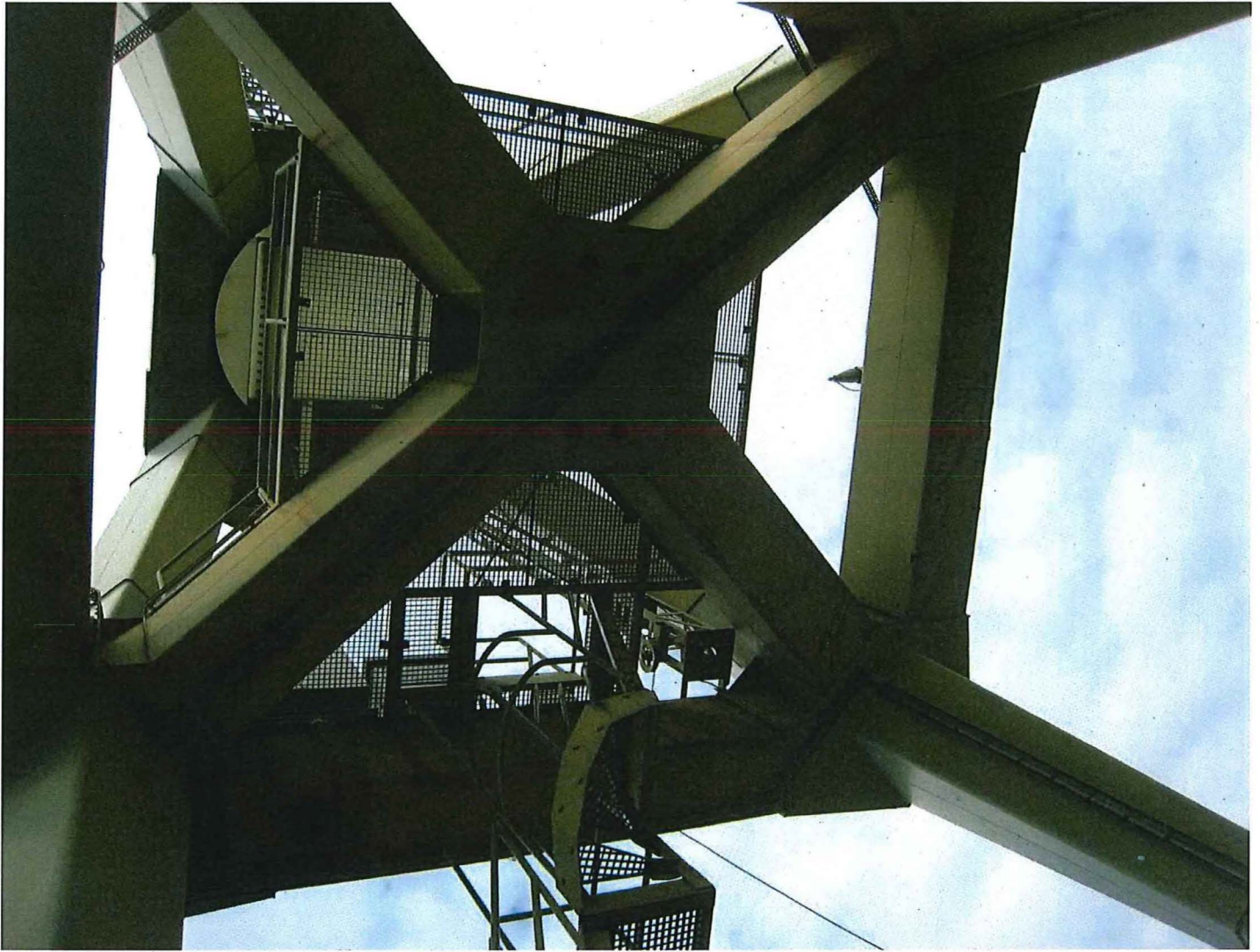
Foto 8: In de poten van het portaal zit een knik. Ter hoogte van die knik zijn de poten onderling verbonden.
