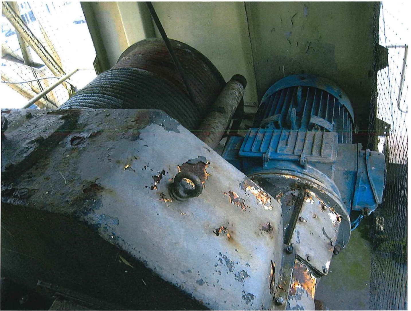
Foto 30: Op het eerste niveau van de toren staat de hijsinstallatie, met elektromotor, overbrenging en kabeltrommel.
