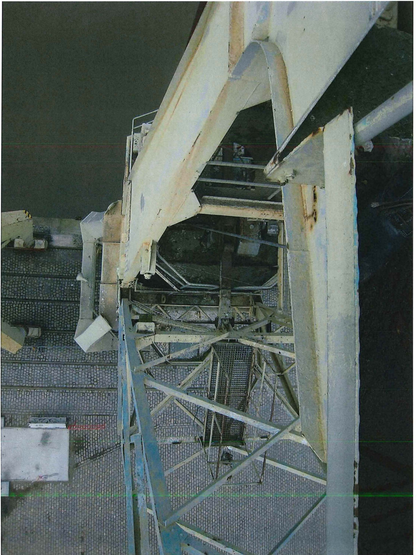
Foto 34: Zicht vanop de top van de toren op de topinstallatie en de tandheugel die de giek beweegt.
