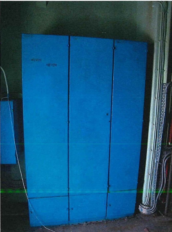
Foto's 20 en 21: De machinekamer bevat de contactorenkast voor het zwenken en toppen (foto boven) en de contactorenkast voor het hijsen en vieren (foto onder).
