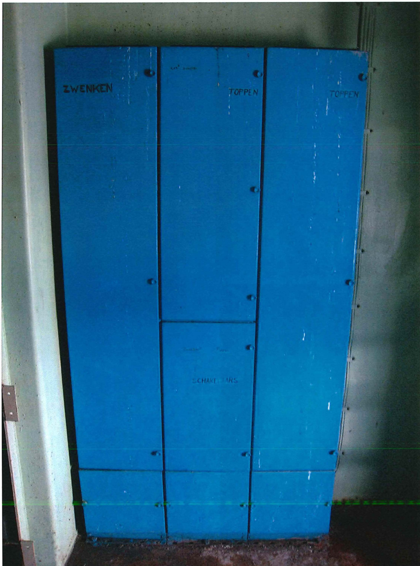
Foto 22: Machinekamer met een kast voor de contactoren en hoofdschakelaars van het zwenken en toppen.
