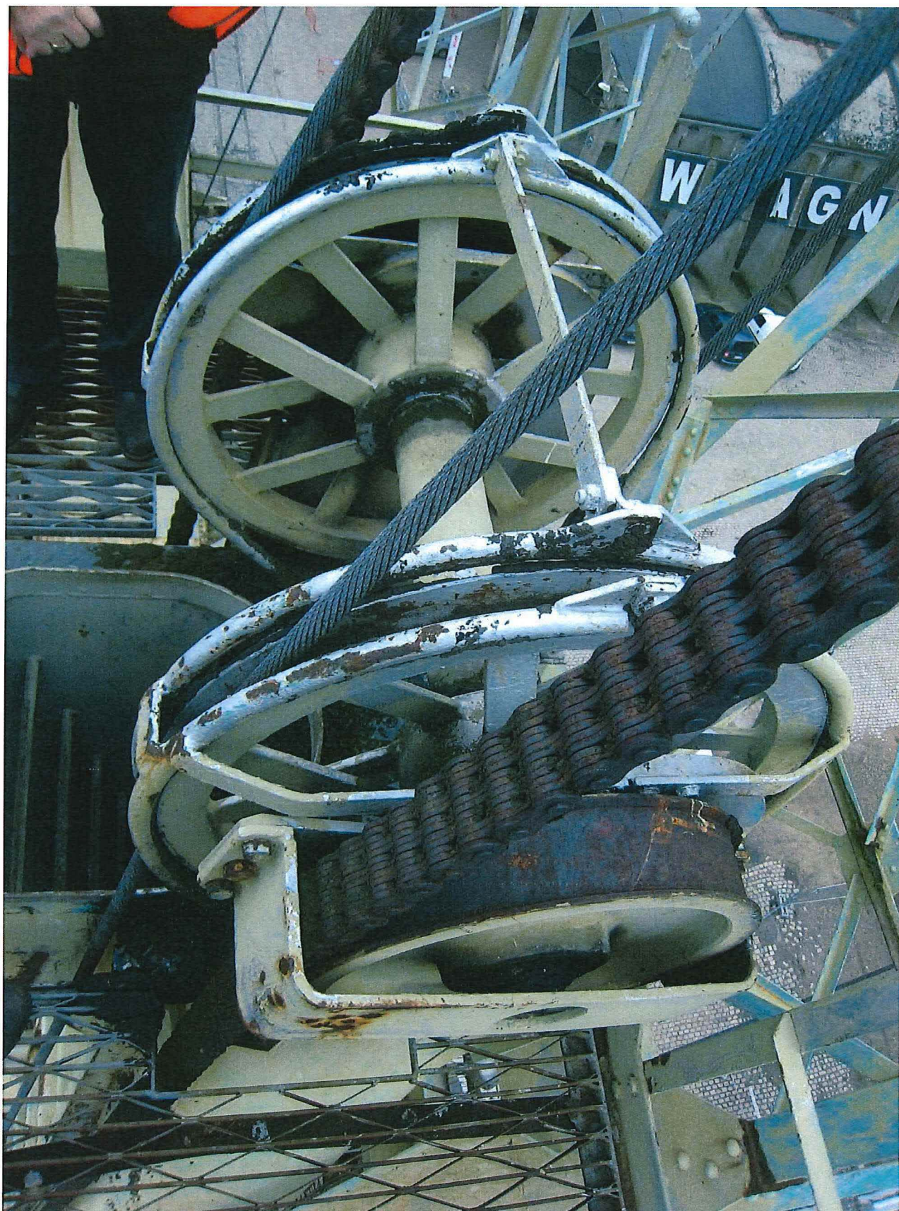
Foto 20: De top van de toren met de geleidingsschijven voor de fleyerkettingen die het tegengewicht aan de giek bevestigen en de kabelschijven van het hijsmechanisme.
