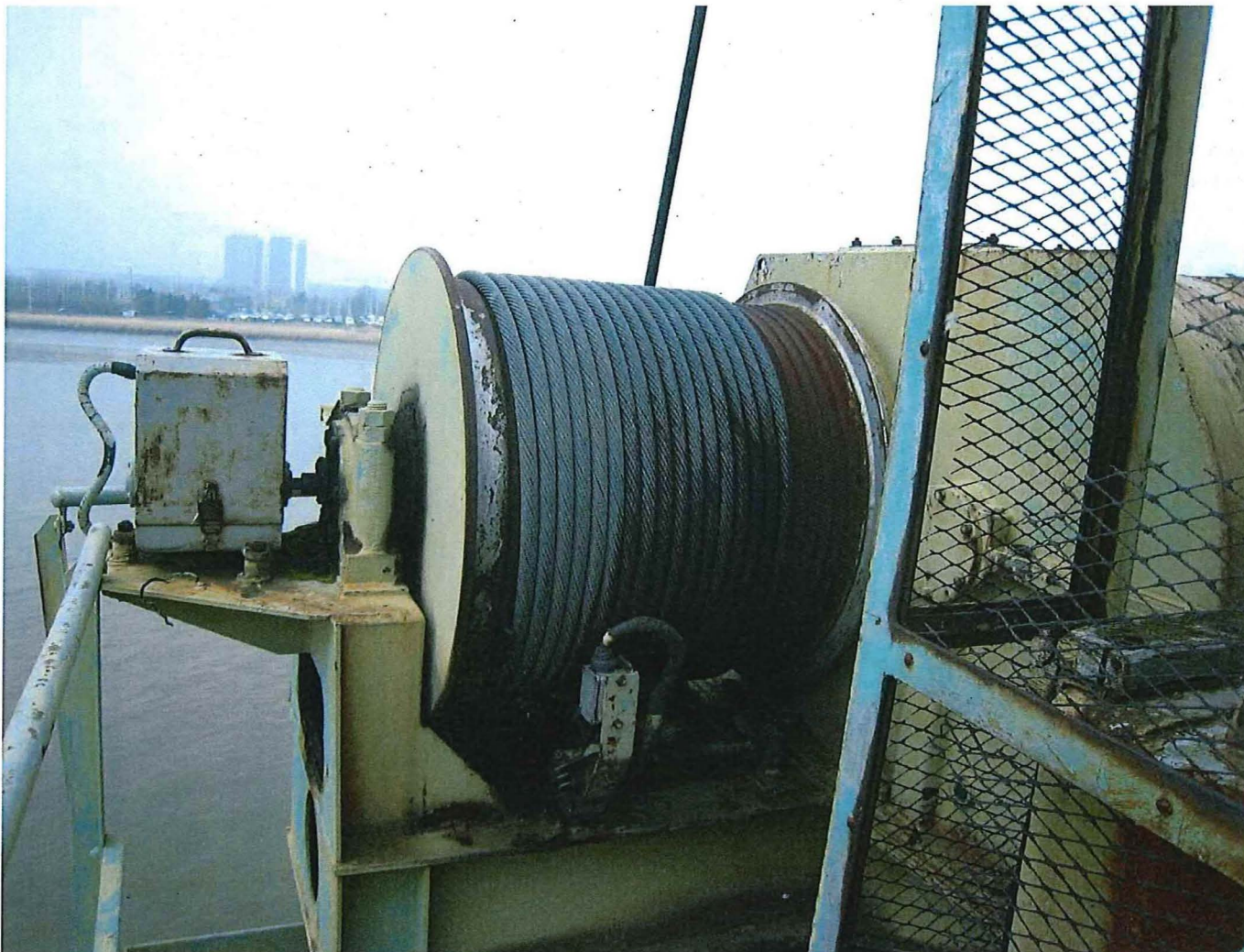
Foto 9: De trommel van de hijskabel op hetzelfde bordes.
