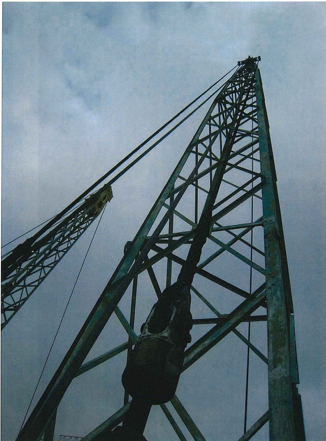
Foto 21: De giek in vakwerk, met centraal op de foto de schakel die één van de kettingen verbindt met de stalen ophangkabel die met de top van de giek is verbonden. Bovenaan de foto is de keerschijf van de hijskabel zichtbaar.
