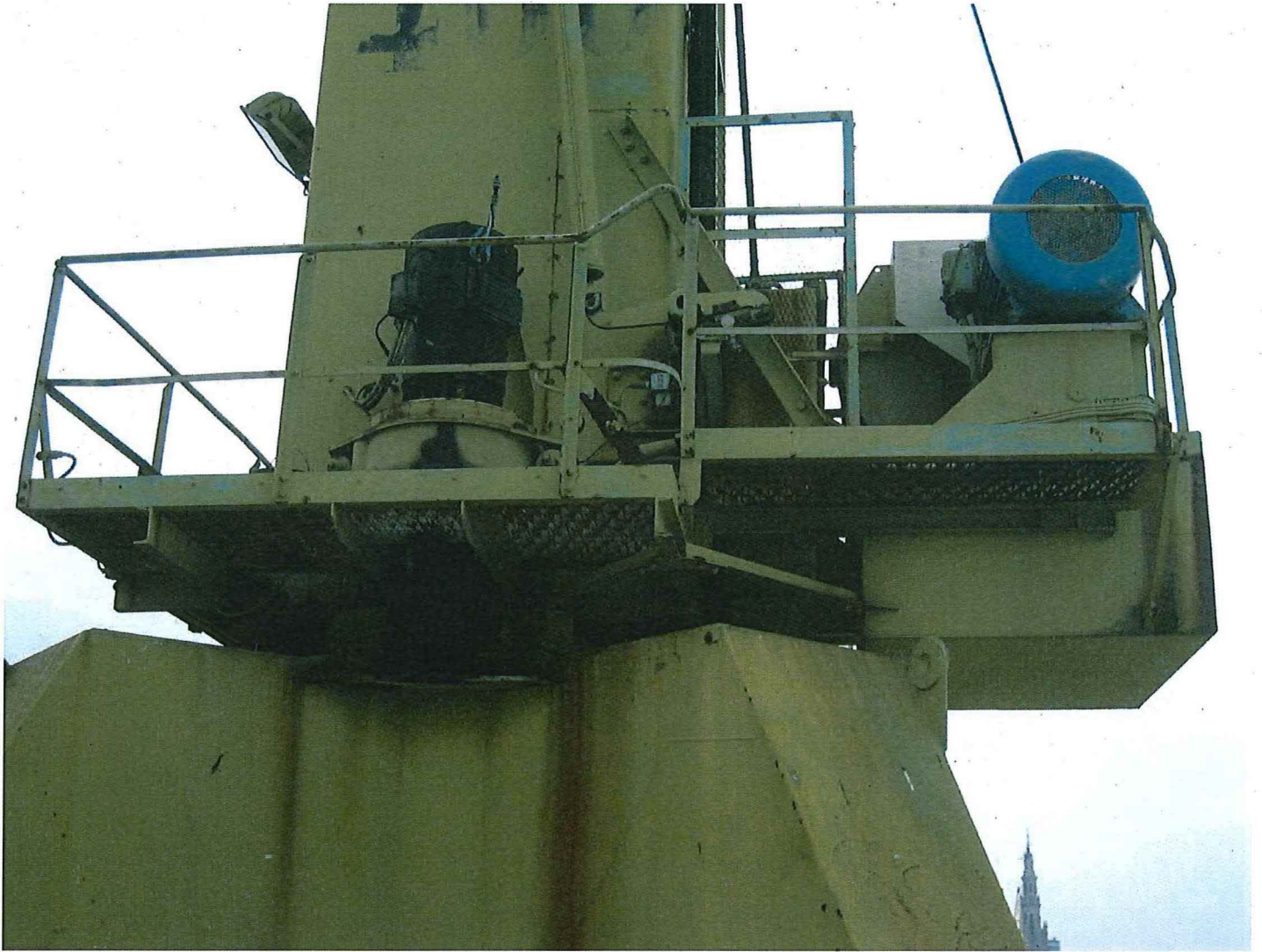
Foto 7: Het bordes ter hoogte van de dubbelrijige zwenklager met het zwenkmechanisme (elektromotor en het rondsel dat onder het bordes zichtbaar is). Aan de rechterkant van de foto is onder de hijsinstallatie het tegengewicht van de toren zichtbaar.
