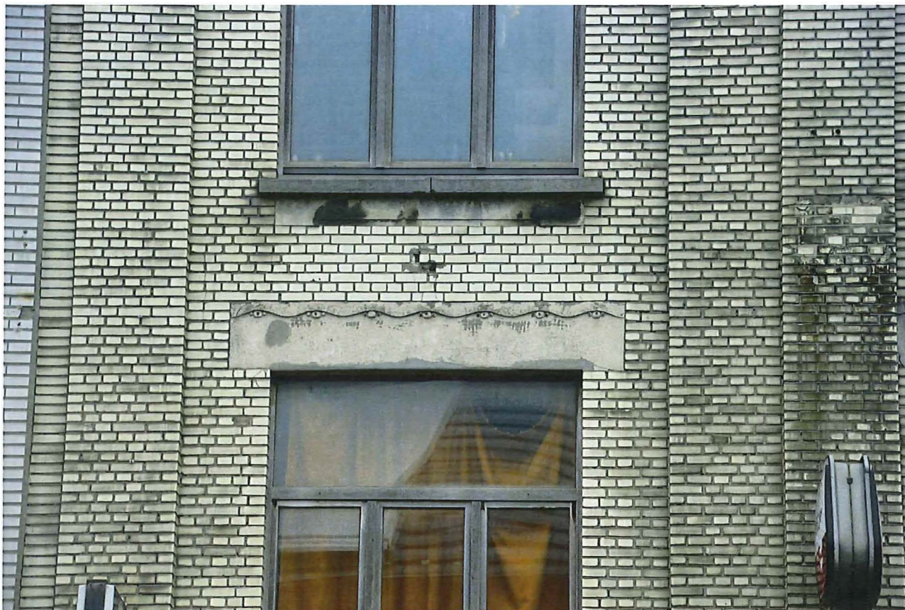
Foto 5: Voorgevel Hundelgemsesteenweg. Detail linkertravee. Dorpel en cementering van de vensters.
