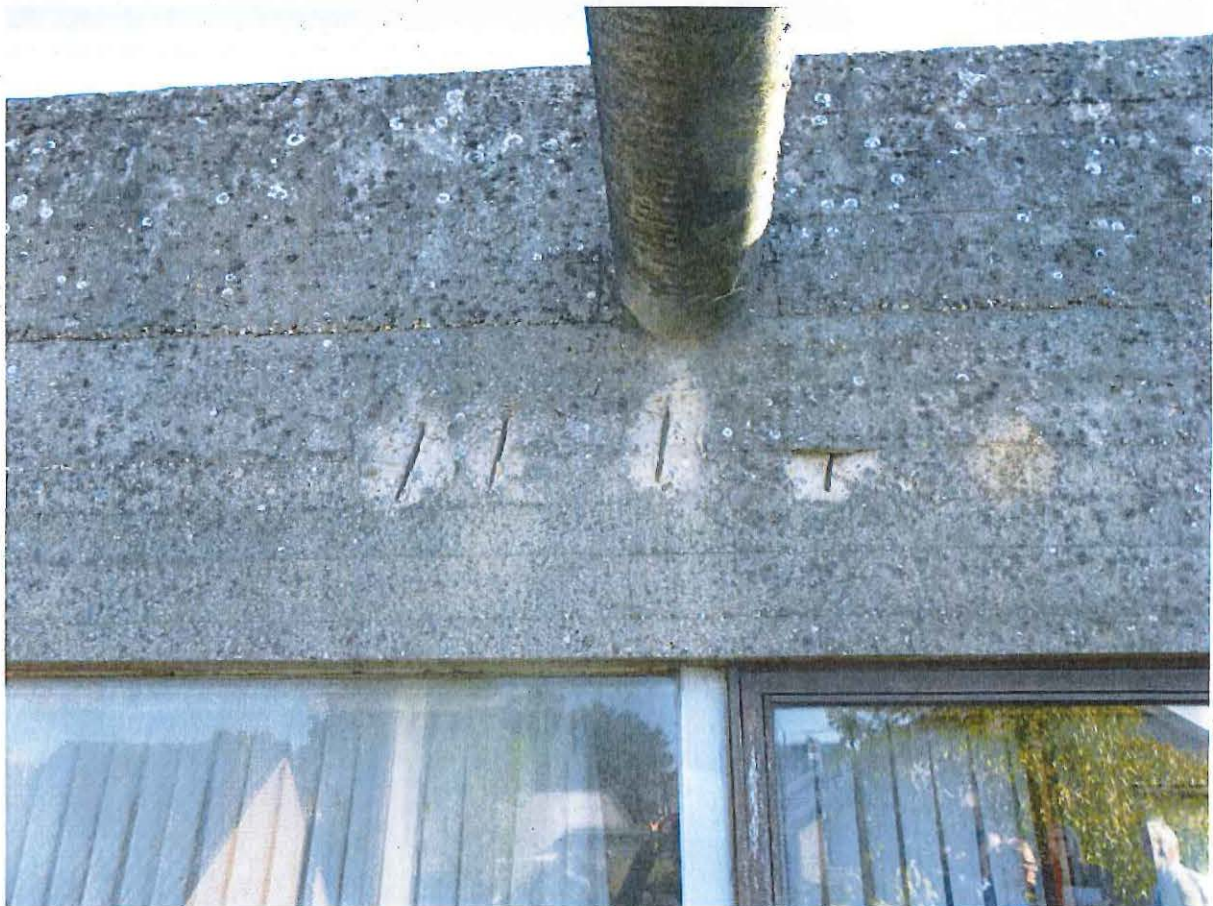
Foto 22: Achtergevel hoofdgebouw, eerste verdieping. Detail betonrot onder de waterafvoer.
