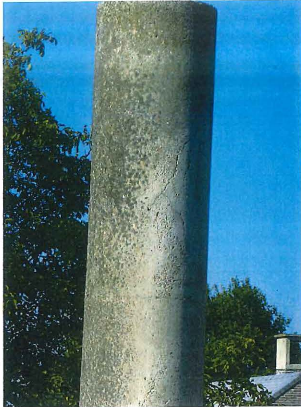
Foto 35: Garage. Detail van de betonnen schouw met barsten.
