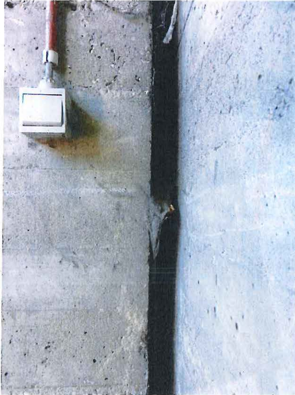
Foto 9: Voorgevel hoofdgebouw. De openingsgleuf tussen voorgevel en hoofdgebouw, ter hoogte van het eerste bordes.
