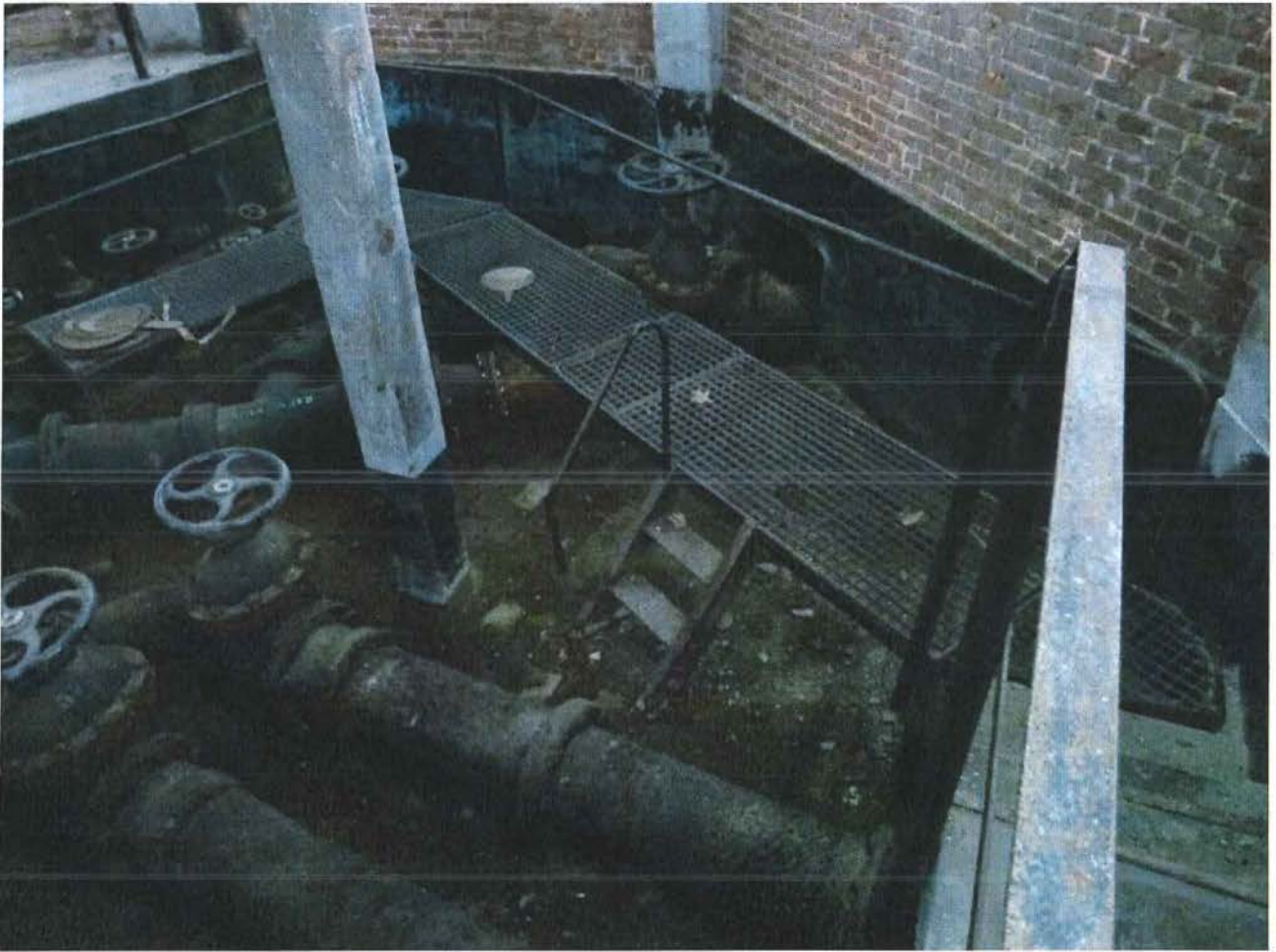
Foto 9: Het souterrain met aan- en afvoerleidingen en passerelle over de leidingen.
