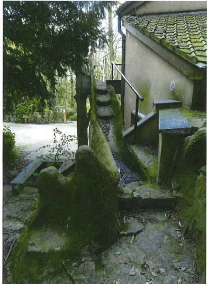
foto 34: detail geëvoeerde omgevallen boom uitgewerkt als afvoergoot
