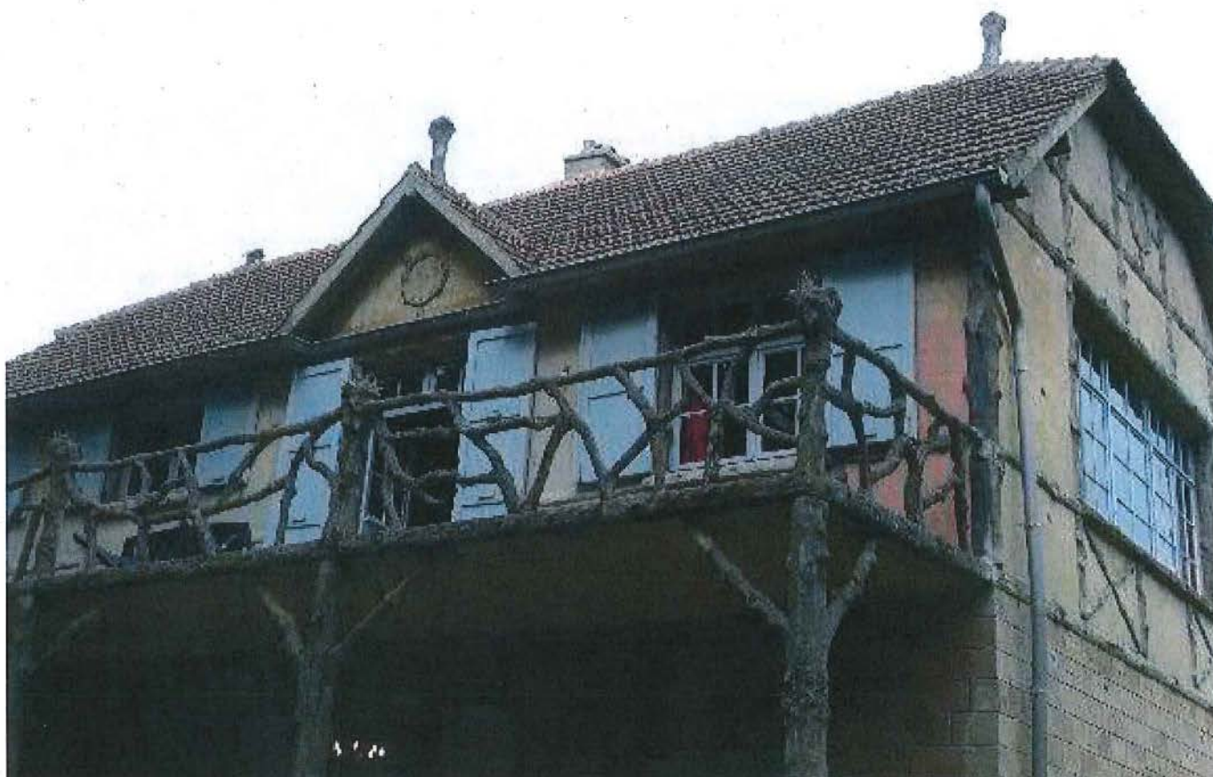
Foto 19: Detail cementrustieke balustrade rond balkon, 1ste verdieping
