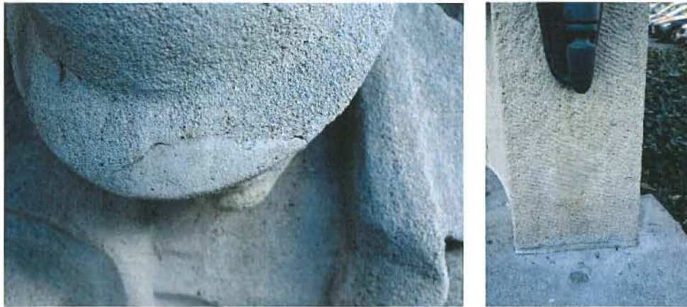
Fig. 12: Oude mortelherstelling aan de helm, 2016
