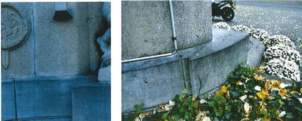
Fig. 16 en 17: Schade aan de voegen, 2016
